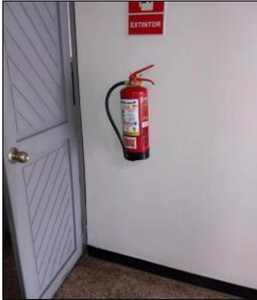
Figura 99 Extintor en un pasadizo.
