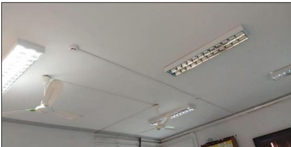
Figura 109 Foto de las instalaciones eléctricas en canaletas en el cielo raso.
