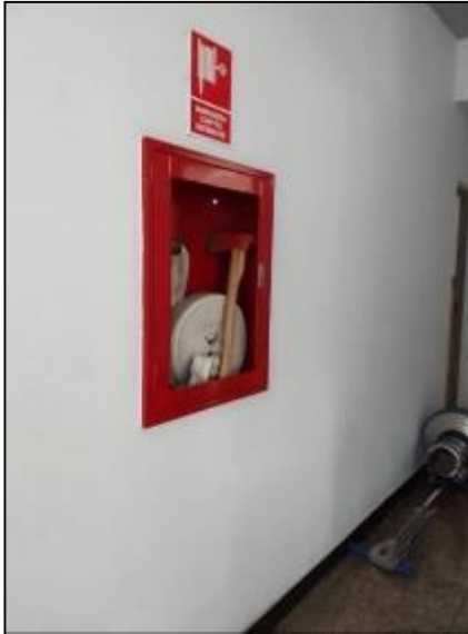
Figura 97 Gabinete contra incendios ubicado en uno de los pasadizos.
