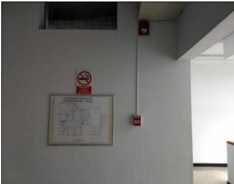
Figura 98 Alarma contra incendios.
