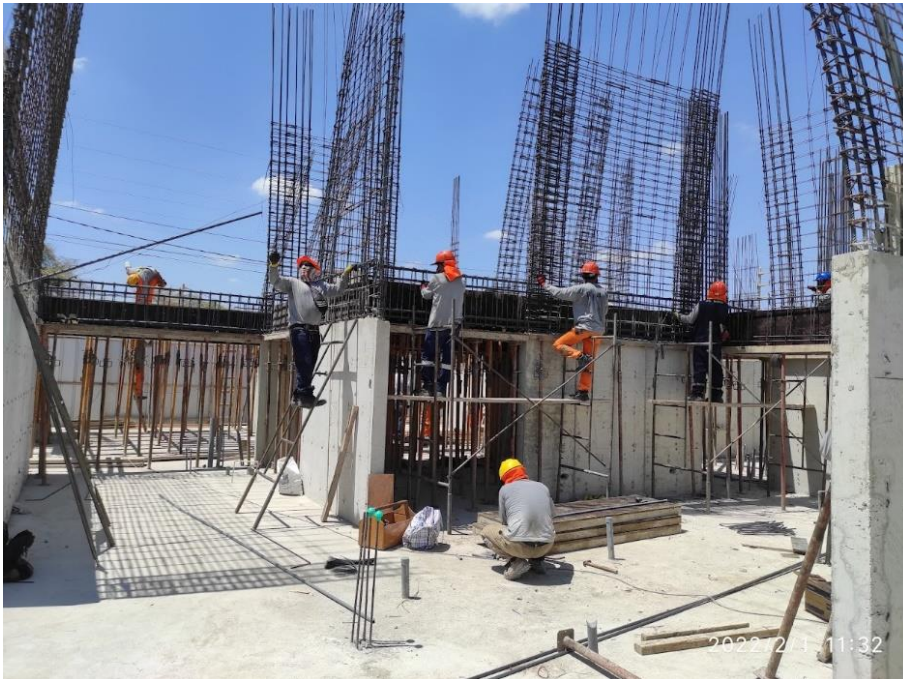
Tejido de Horizontales y Verticales 2do nivel sector 1 y 2 de edificio Poncianas
