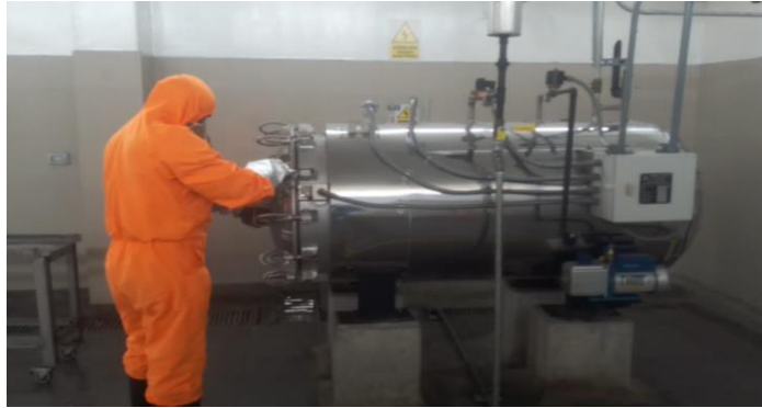
Figura 8: Servicio de Autoclavado de Biocontaminados.
