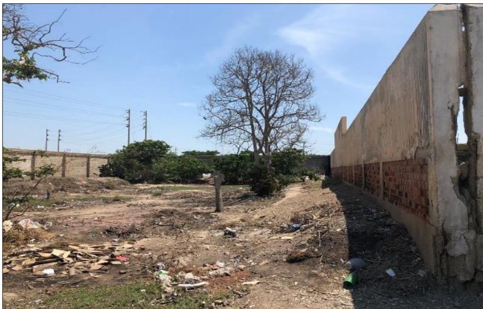
Figura N° 14: Fotografía del ambiente que pertenece a la parte posterior del terreno, observamos la existencia de desmonte en el comienzo hasta el final y en la parte derecha de la foto observamos el muro perimétrico también deteriorado a punto de colapsar.
