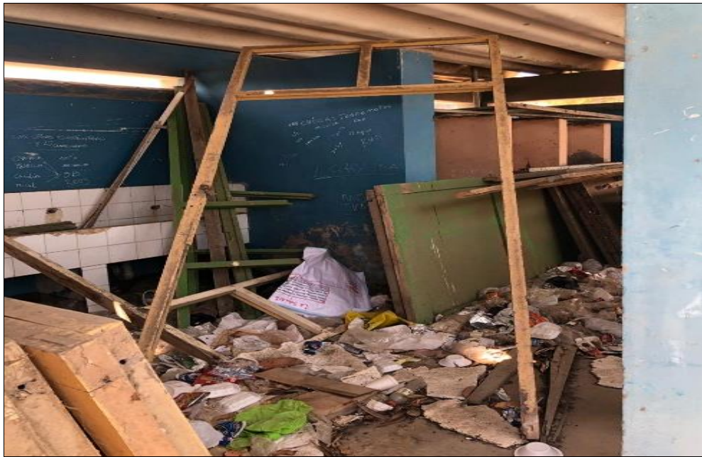
Figura N° 13: Fotografía interior de uno de los servicios higiénicos actualmente usados como almacenes para los desperdicios de obras, equipamiento malogrado y mobiliario defectuoso que lleva 5 años abandonado.
