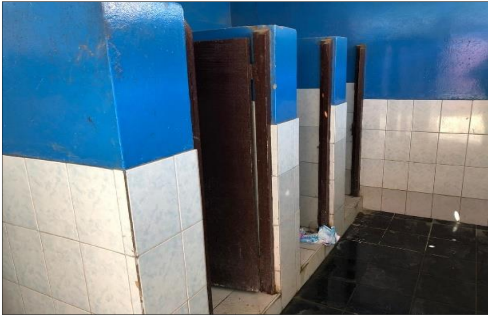
Figura N° 09: Fotografía interior de los servicios higiénicos para hombres que se siguen usando en condiciones insalubres por los alumnos, la mayoría de módulos de baño se encuentran sin puertas, sin mobiliario sanitario, con tuberías de agua y desague rotas.
