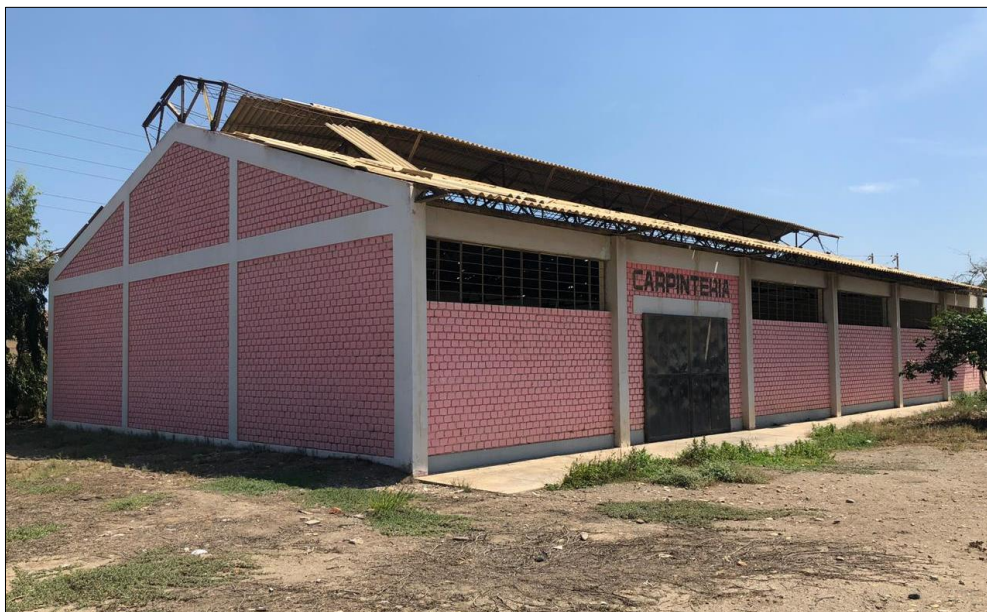
Figura N° 12: Fotografía del taller de carpintería sin cubierta, actualmente este ambiente se encuentra abandonado y con acceso restringido para todo tipo de persona, las máquinas y los demás mobiliarios, se encuentran malogrados por encontrarse expuestos.
