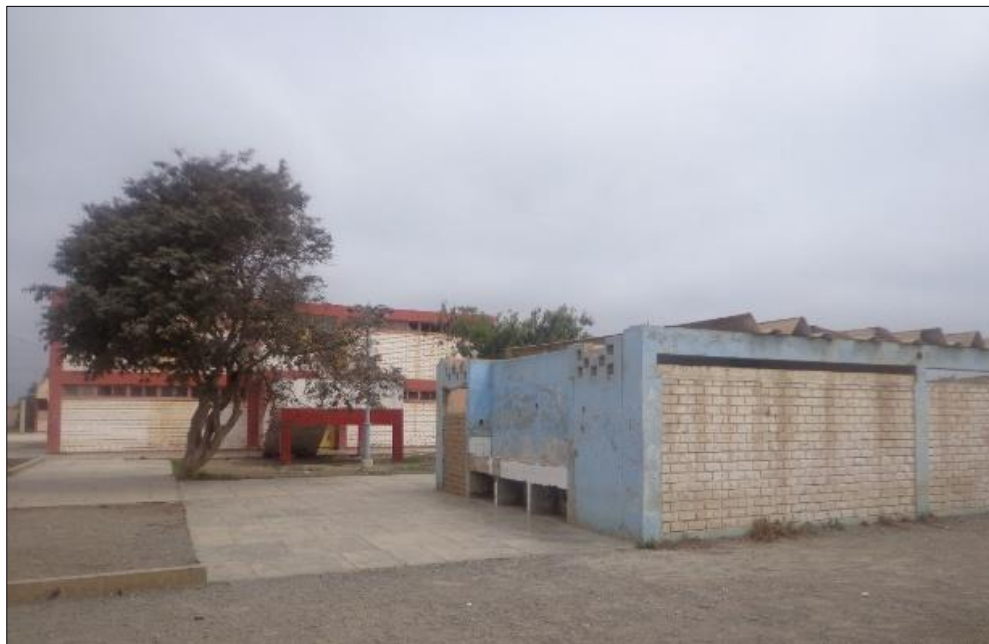
Figura N° 08: Fotografía en esquina de los servicios higiénicos, que actualmente no cumplen su función y son usados como almacenes para el mobiliario defectuoso, por otro lado, la cubierta de estos ambientes son calaminas con material de asbesto.
