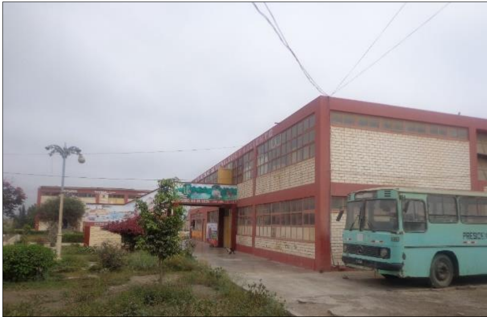
Figura N° 07: Fotografía en esquina de los pabellones de aulas de 1er y 4to año de secundaria, se pueden apreciar las ventanas antiguas rotas o en mal estado y la escalera de acceso hacia el segundo nivel con una estructura deficiente.
