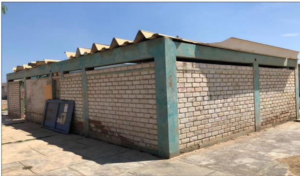
Figura N° 10: Fotografía en esquina de los servicios higiénicos de mujeres, tiene techo de calamina de asbesto y sólo funciona un lado de toda la infraestructura, el otro lado se encuentra sin mobiliario y con carpetas en mal
