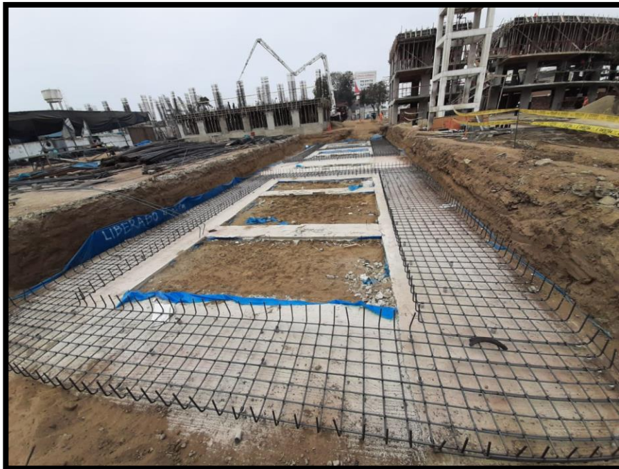
Verificación de vaciado de solado y habilitación de acero de refuerzo para zapatas, para determinación de rendimiento de mano de obra
