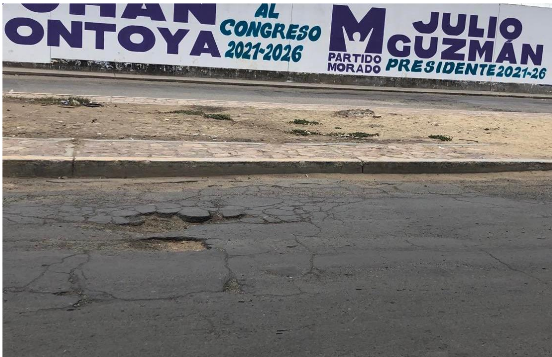
Fallas en el pavimento en el tramo de la Av. Federico Villarreal y Prol. Unión tales como ahuellamiento, hundimiento, piel de cocodrilo, baches
