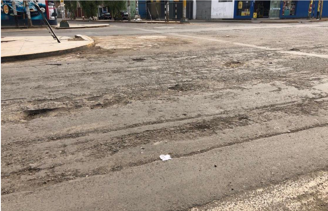
Fallas en el pavimento de la zona de estudio como ahuellamiento, hundimiento, agrietamiento, fisuras longitudinales, transversales, en bloques de severidad alta
