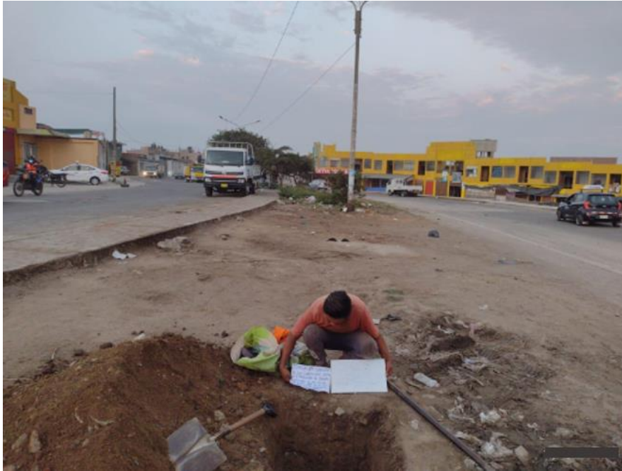
Vista panorámica de la calicata C-8 , nótese en la superficie el material de relleno conformado suelo orgánico, arena y algunas piedras. A continuación, se encontró un estrato de Arenas arcillosas ( SC ) de color marrón claro, de consistencia media y regular humedad. No se encontró el Nivel de aguas freáticas (NAF).
