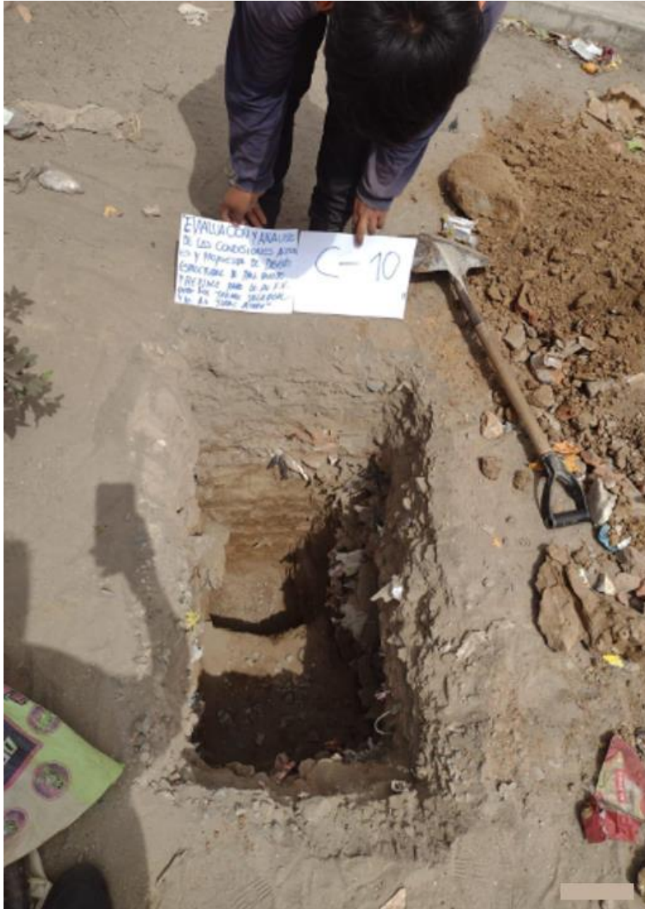
Vista del perfil estratigráfico de la calicata C-10 , nótese en la superficie el material de relleno conformado suelo orgánico, arena y algunas piedras. A continuación, se encontró un estrato de Arenas pobremente graduadas con pocos limos ( SP-SM ), de color beige pardo a amarillo claro, de consistencia media y regular humedad. No se encontró el Nivel de aguas freáticas (NAF).
