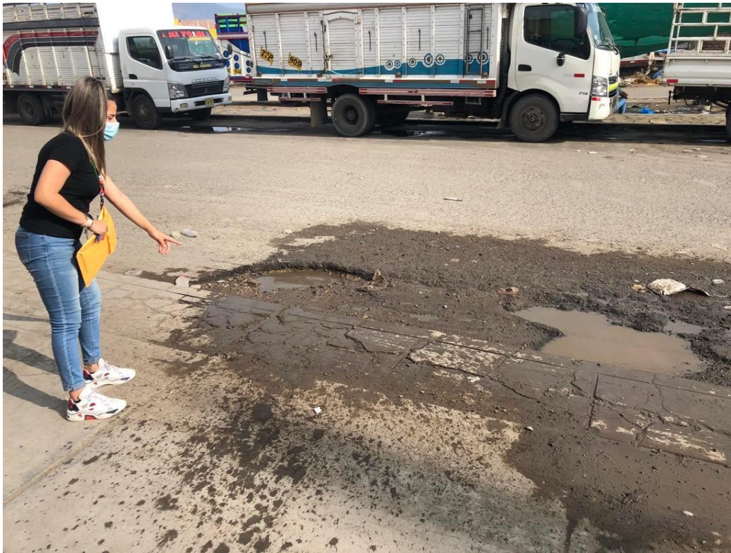
Baches asfálticos de gran diámetro (severidad alta) en el tramo de la Av. Federico Villarreal cerca al mercado Hermelinda
