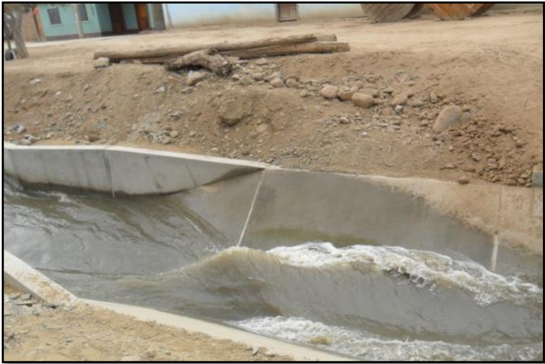
Figura 34: Rastro del desborde al límite de la pared lateral a la salida de la tercera caída vertical del canal, producto del resalto hidráulico no disipado con un caudal menor de 3.8 \text{ m}^3/\text{s} .
