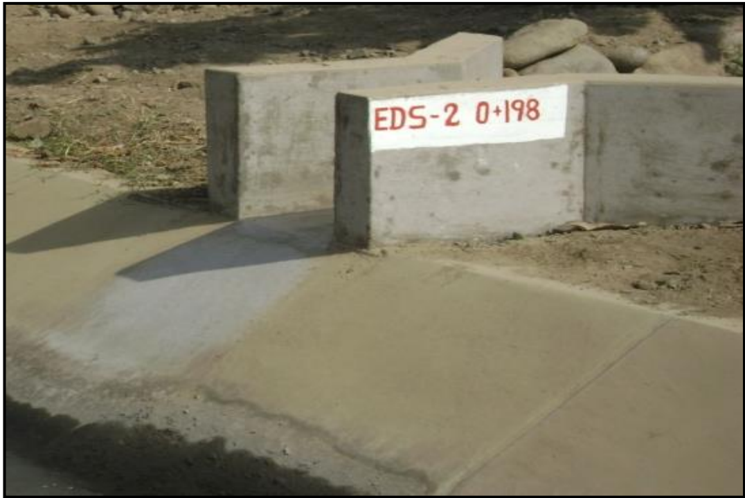
Figura 28: Entrega de desagüe superficial EDS-2, ubicado en la progresiva 0+198.
