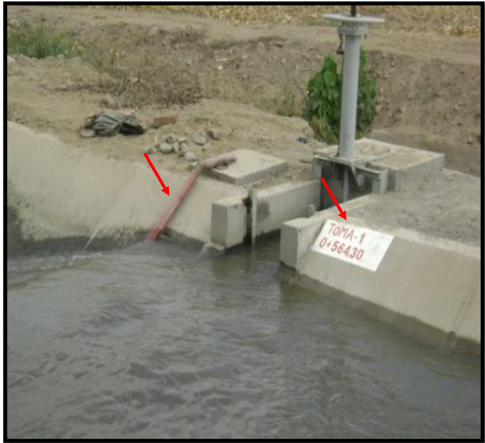
Figura 64: Se muestra la toma lateral y la estructura metálica ubicada para elevar el nivel del agua. Progresiva 0+564.30
