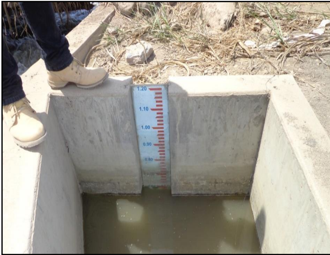
Figura 29: Estructura de aforo donde se observa que el tirante actual es de 0.60 m para un caudal menor de 3.8 \text{ m}^3/\text{s} , cuyo tirante debería ser 0.93 m según diseño.
