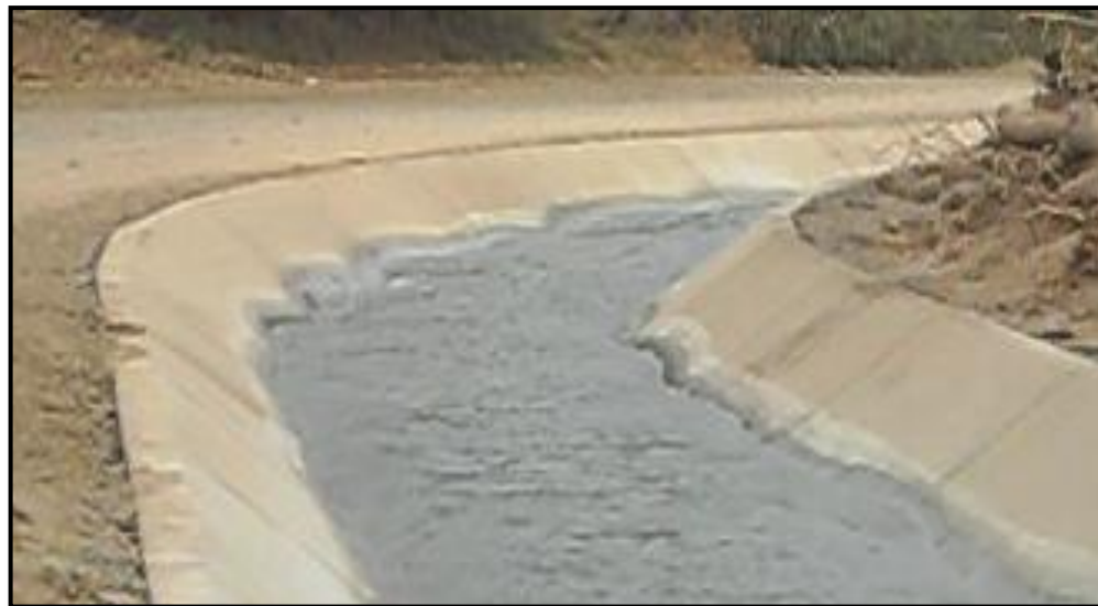
Figura 37-38: Primer Tramo, con flujos turbulentos desordenados y formación de oleajes en curvas horizontales.
