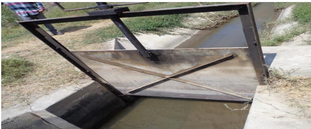
Figura 25: Compuerta de Tomas laterales (Toma 2)
