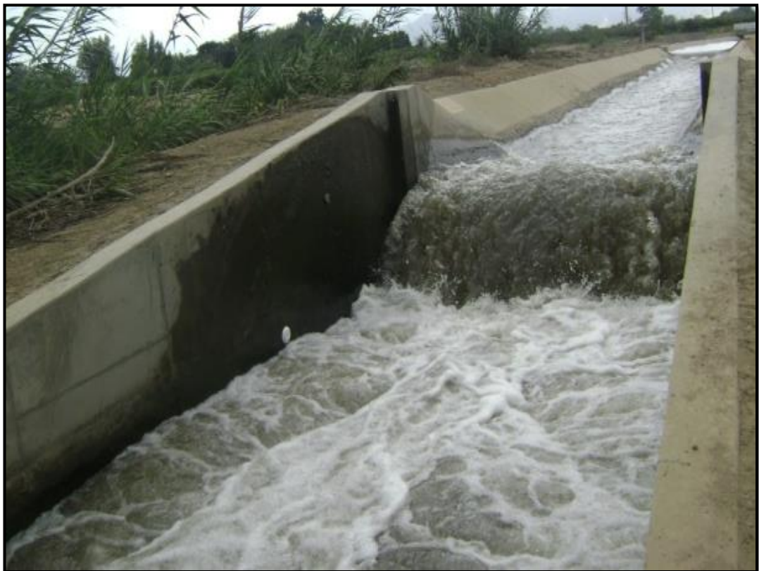
Figura 44-45: Marca en las paredes por resalto hidráulico (Primera y Segunda Caida
