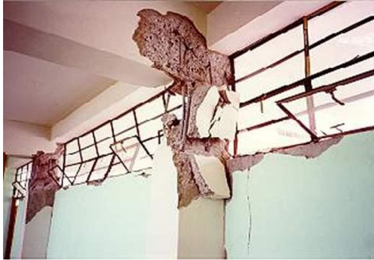
Figura 65- Falla por corte de una columna.
