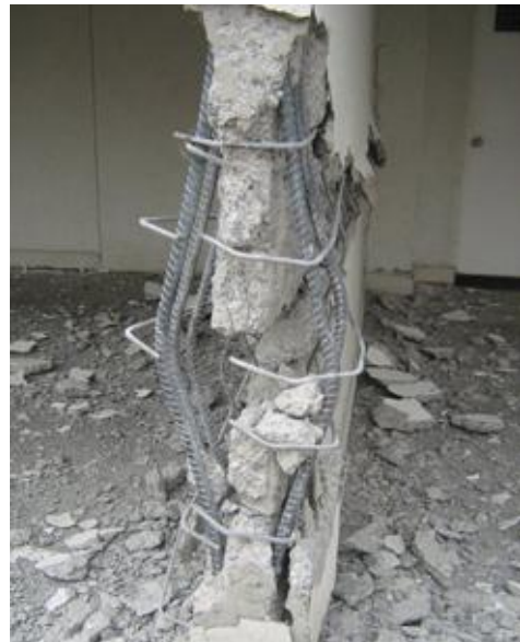
Figura 68- Falla por confinamiento en una columna.
