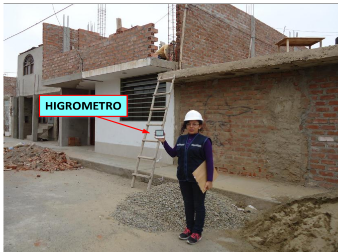
Figura 31 - Toma de datos de temperatura y humedad del sector.
