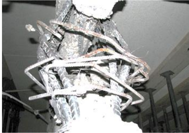
Figura 61- Columna que presenta una falla por compresión.
