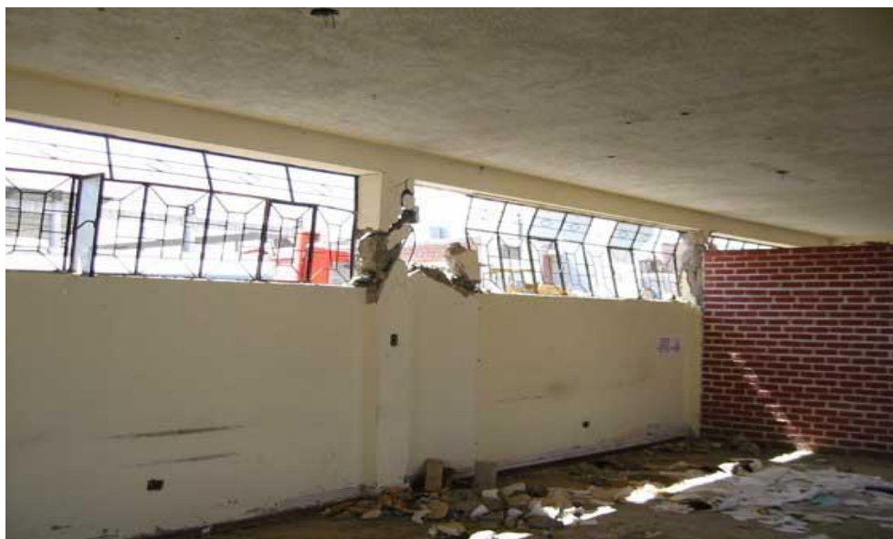
Figura 72- Falla por columna corta en una columna.
