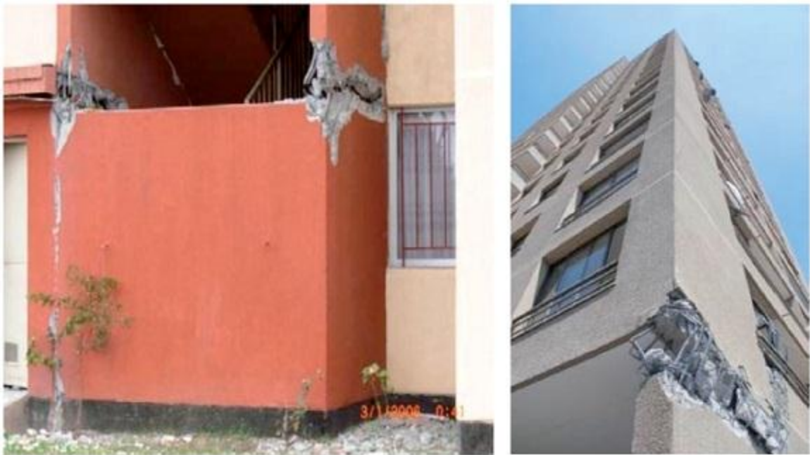
Figura 70- Fallas por corte en muros de concreto.
