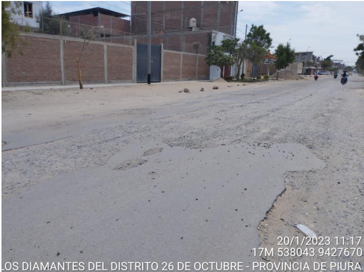
Foto 2. Deterioro de la Avenida Los Diamantes (17 M 538043 9427670)
