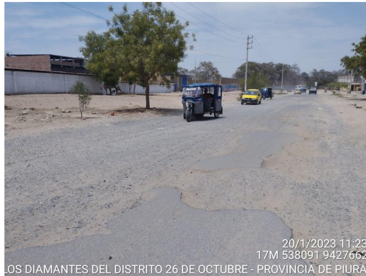
Foto 3. Deterioro de la Avenida Los Diamantes (17 M 538091 9427662)
