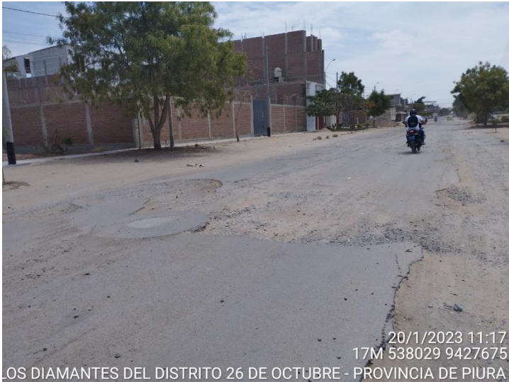
Foto 1. Deterioro de la Avenida Los Diamantes (17 M 538029 9427675)
