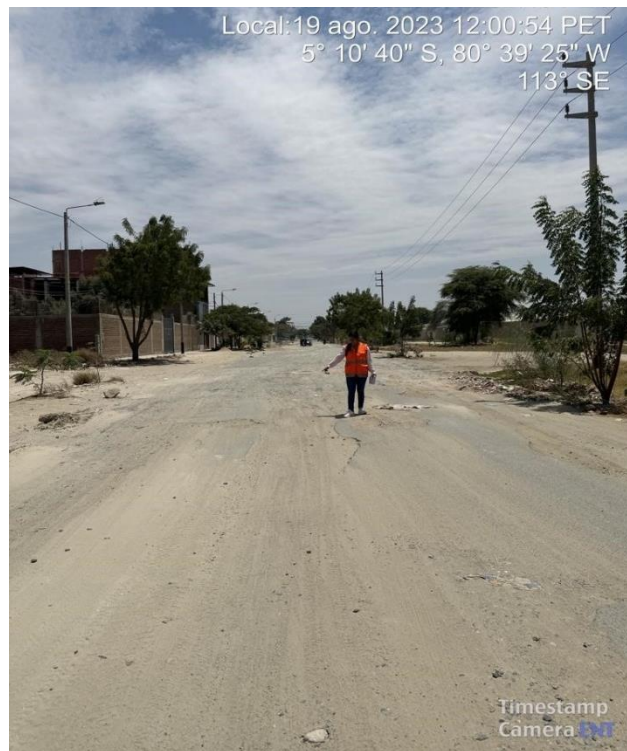
Foto 15. Identificación de fallas existentes en nuestra área de estudio
