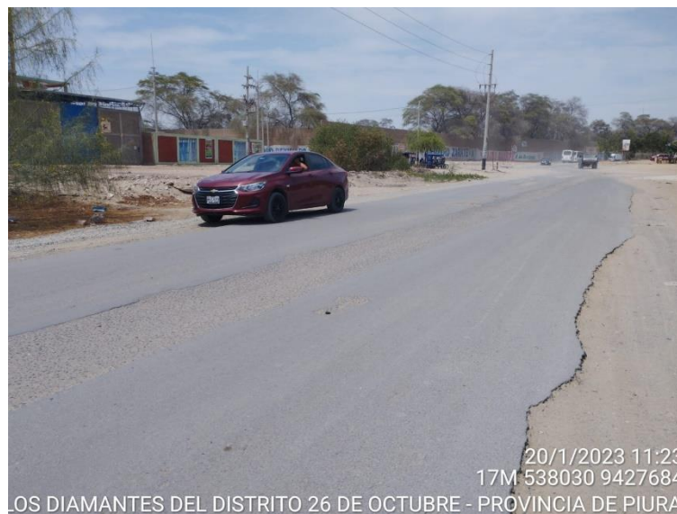
Foto 4. Deterioro de la Avenida Los Diamantes (17 M 538030 9427684)
