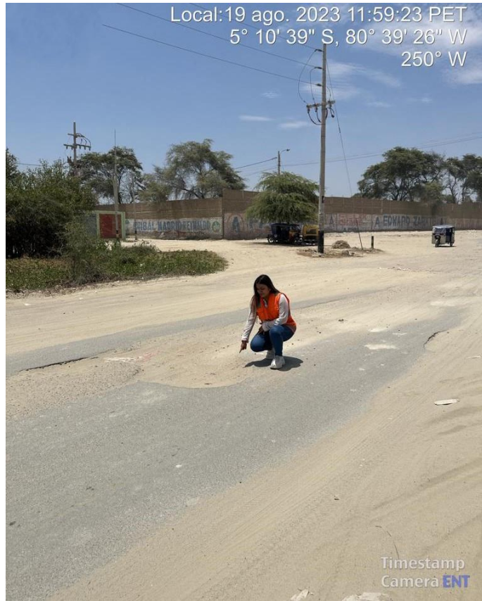
Foto 16. Identificación de fallas existentes en nuestra área de estudio
