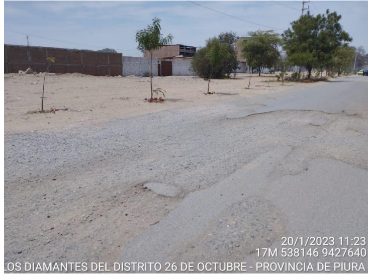
Foto 6. Deterioro de la Avenida Los Diamantes (17 M 538146 9427640)
