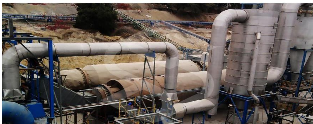
Secador por aire caliente instalado
