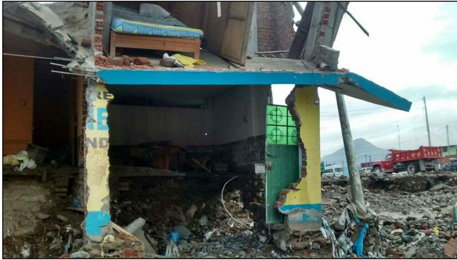
Figura N° 126: Vivienda afectada por Inundación (Fuente: Los Autores)
