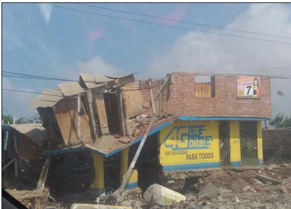
Figura N° 125: Vivienda afectada por Inundación (Fuente: Los Autores)
