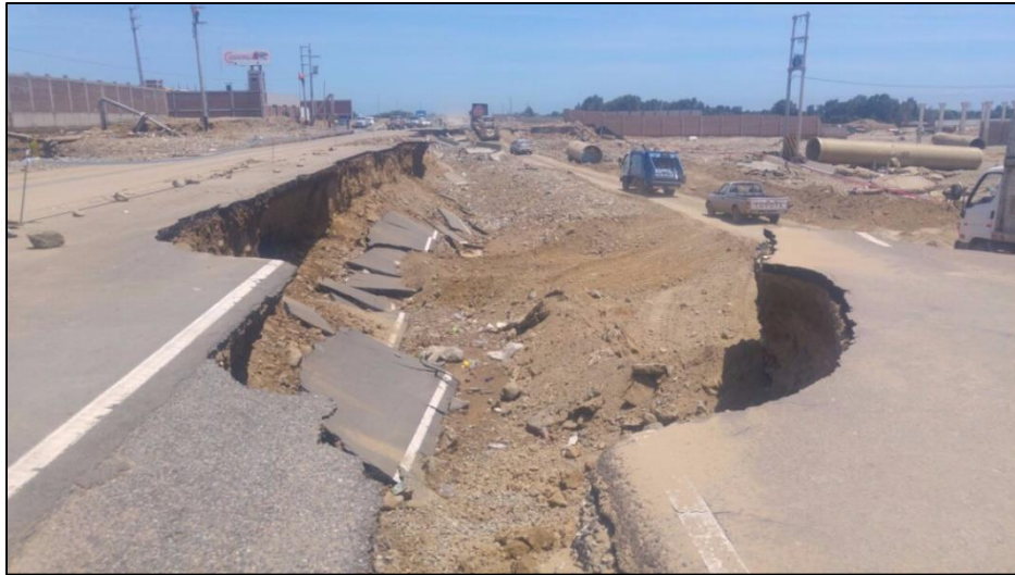
Figura N° 128: Vía de Evitamiento Inhabilitada (Fuente: Los Autores)
