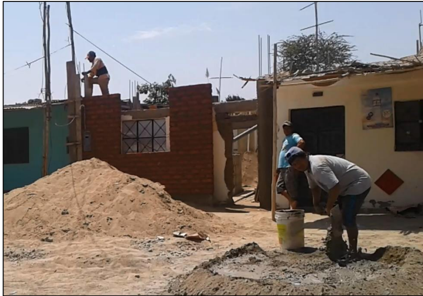
Figura N° 34: Armado de muros de fachada con columnas Sector III - El Milagro (Fuente: Los Autores)
