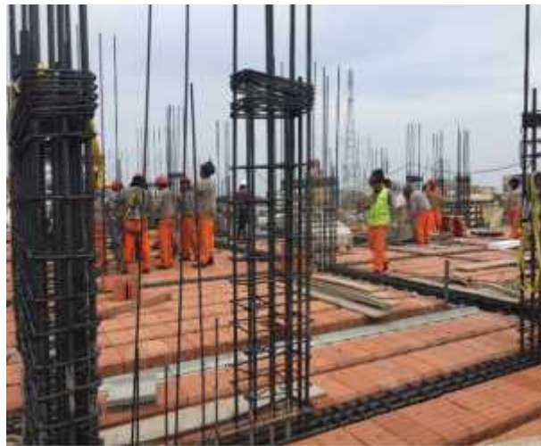
Figura 68: Trabajos para colocación de losa aligerada con sistema vigueta bovedilla – COAM – Trujillo 2016
