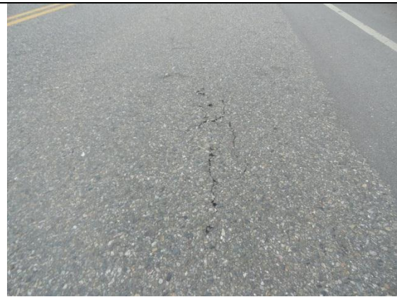
Tramo Individual 10: Cavico – Pte. Chamaya II Fisura en Calzada Severidad: Baja Km 150+870
