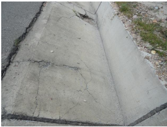
Tramo Individual 10: Cavico – Pte. Chamaya II Falla Estructural en Cuneta Severidad: Media Km 162+135
