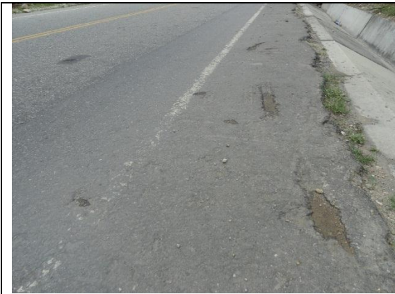
Tramo Individual 10: Cavico – Pte. Chamaya II Hueco en Berma Severidad: Baja Km 150+855
