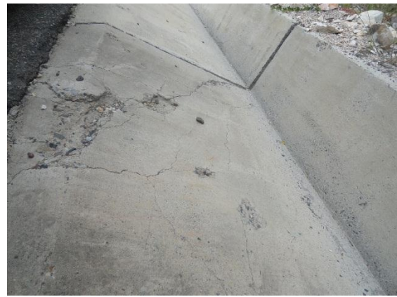
Tramo Individual 10: Cavico – Pte. Chamaya II Falla Estructural en Cuneta Severidad: Media Km 162+182
