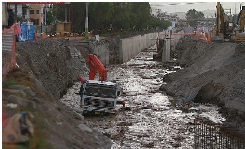
Imagen 1. Torrentera ocupada con material de construcción en bordes Fuente: elaboración propia, 2019
