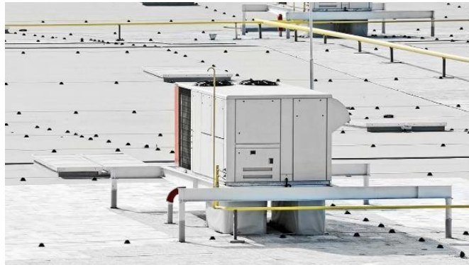
Imagen N° 64: Equipos Roof-Top con Free-Cooling. Fuente: Google Chrome
