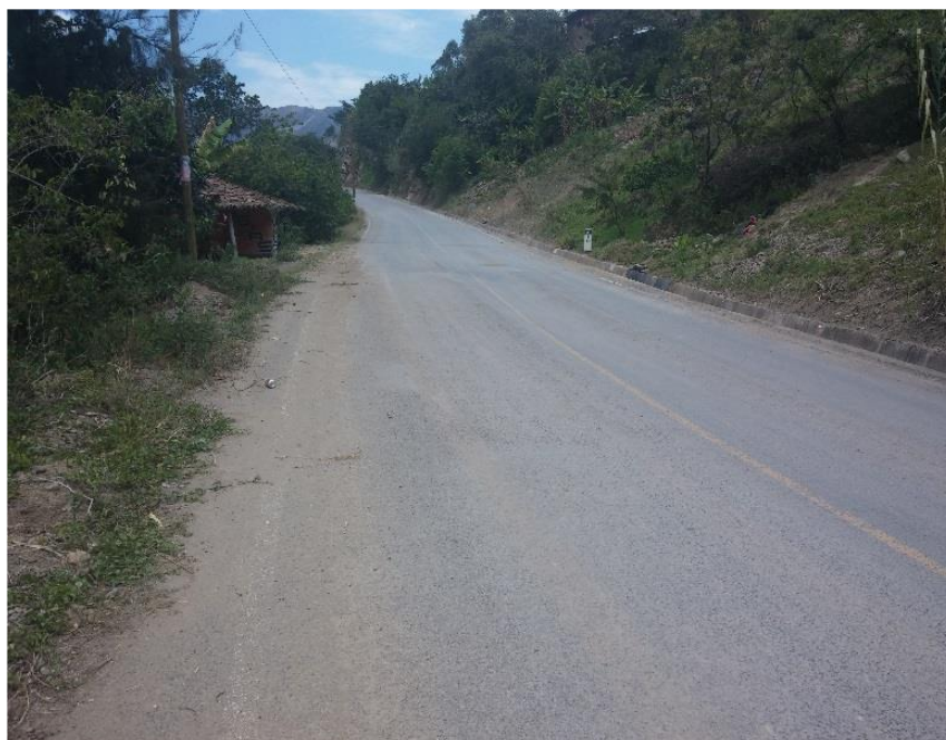
Figura 62: Unidad De Muestra - 15. Peladura De Severidad Alta.
