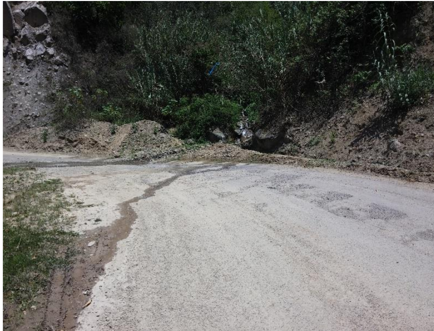
Figura 57: Unidad De Muestra - 10. Peladura De Severidad Alta.
