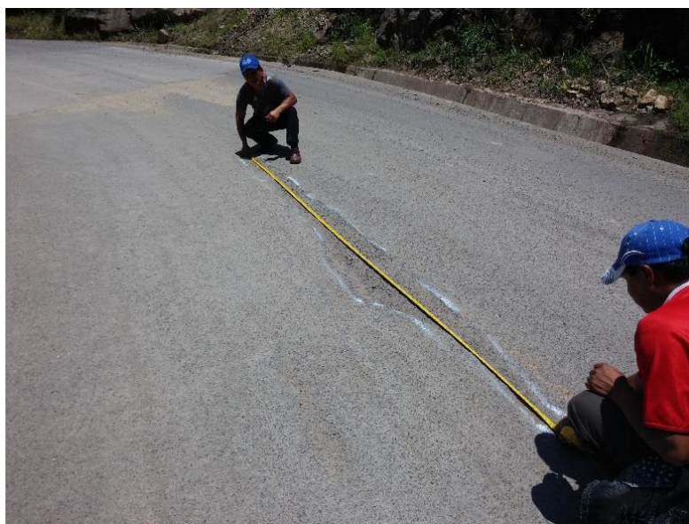
Figura 56: Unidad De Muestra - 09. Corrugación De Severidad Media.
