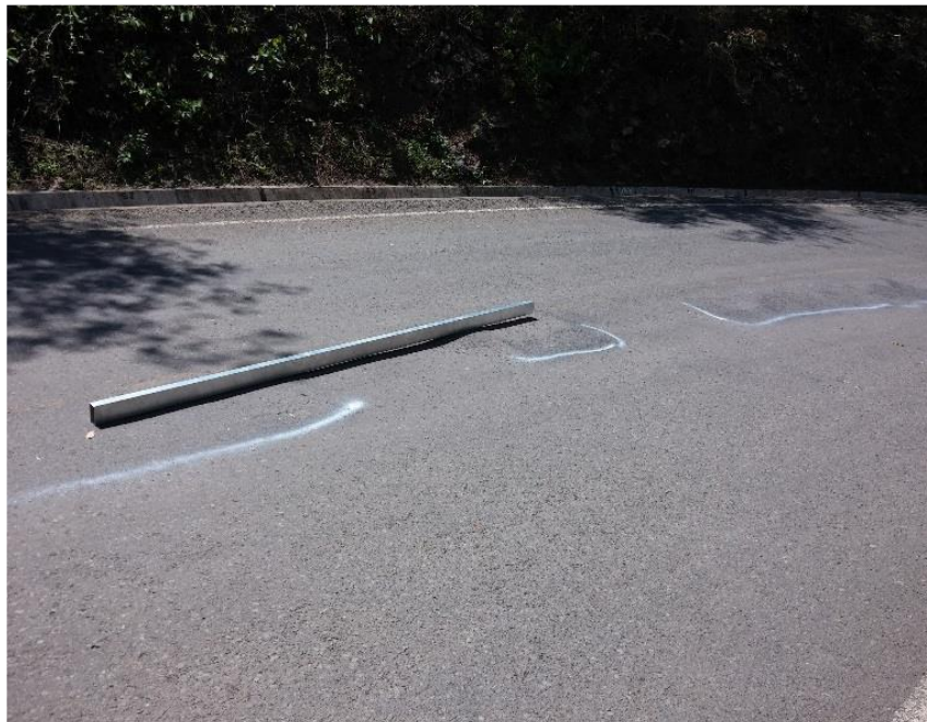
Figura 52: Unidad De Muestra - 05. Corrugación De Severidad Media.
