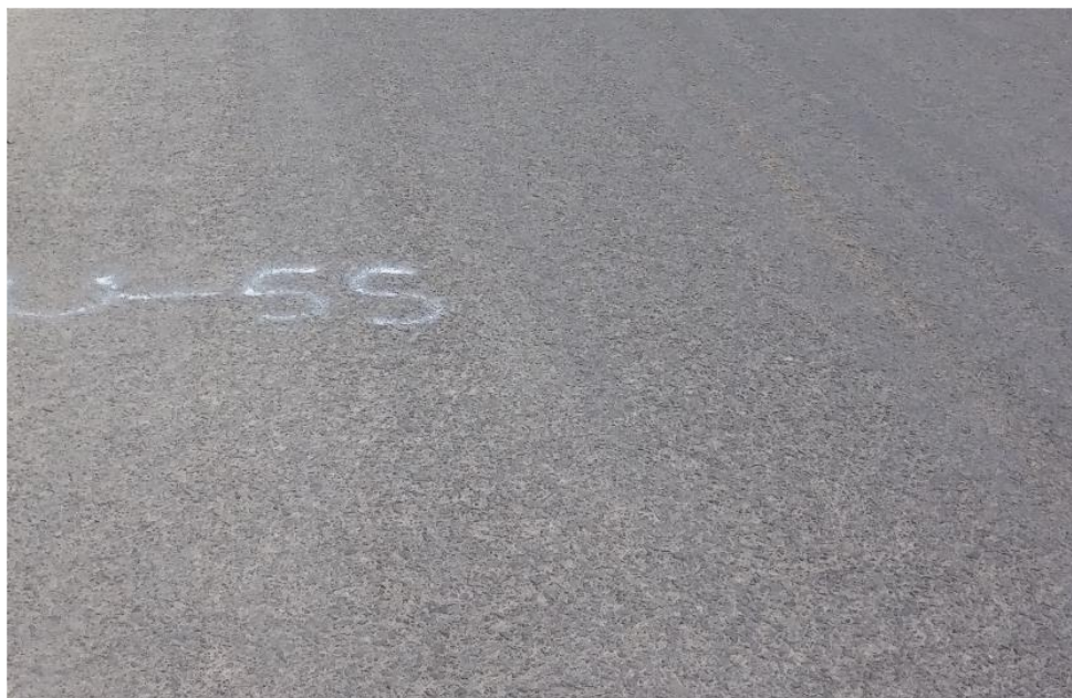
Figura 102: Unidad De Muestra - 55. Peladura De Severidad Baja.
