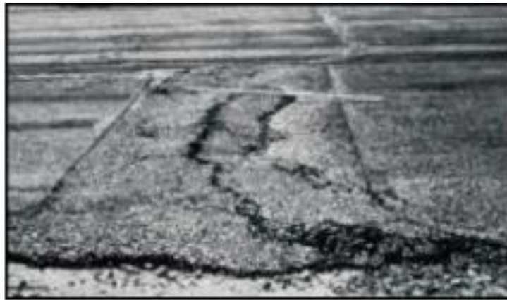
Figura 20: Hinchamiento De Alta Severidad. (Fuente: Rodríguez, 2009).
