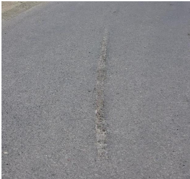
Figura 54: Unidad De Muestra - 07. Fisura Longitudinal De Severidad Media.
