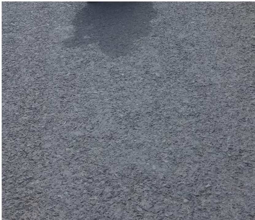
Figura 78: Unidad De Muestra - 31. Peladura De Severidad Baja.
