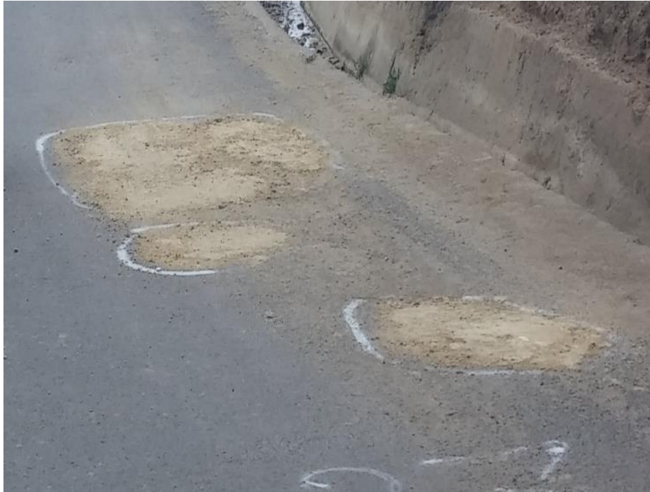
Figura 75: Unidad De Muestra - 28. Parches De Severidad Alta.
