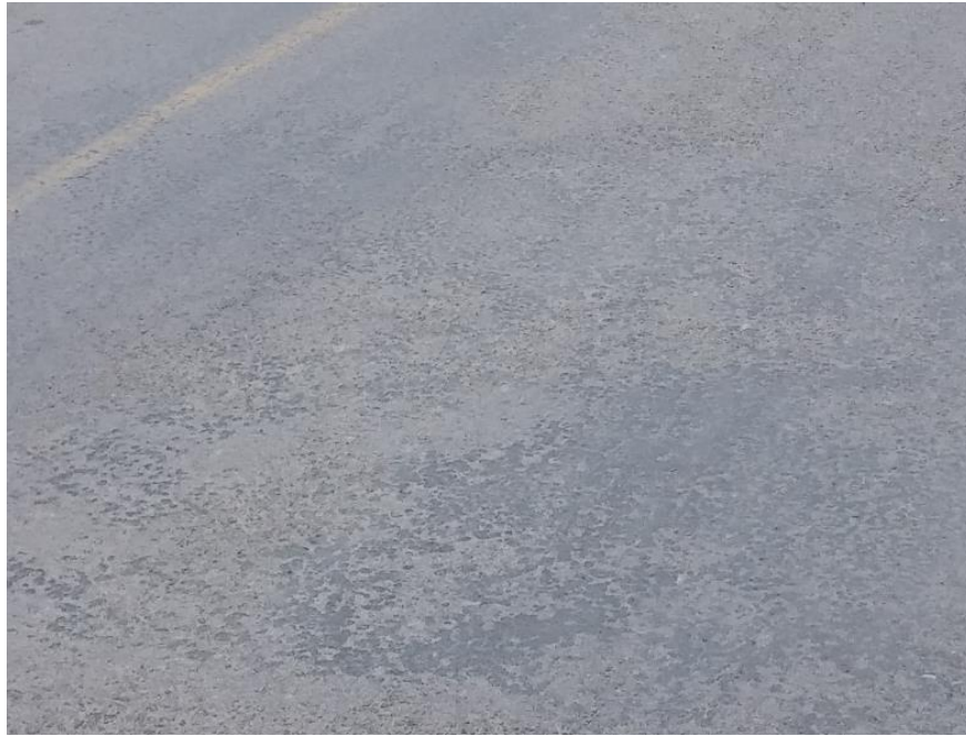
Figura 63: Unidad De Muestra - 16. Peladura De Severidad Alta.
