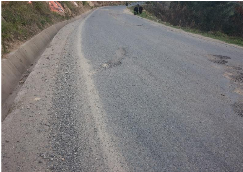
Figura 100: Unidad De Muestra - 53. Estado De Pavimento Muy Malo.
