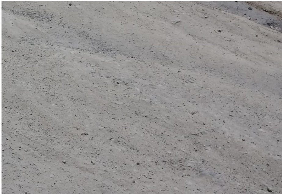
Figura 60: Unidad De Muestra - 13. Peladura De Severidad Alta.
