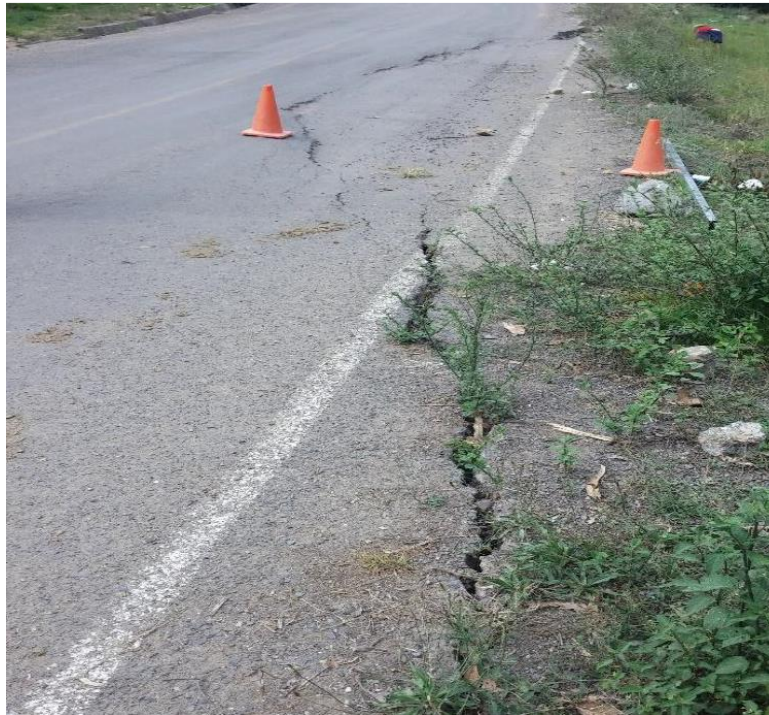
Figura 85: Unidad De Muestra - 38. Depresión De Severidad Media.
