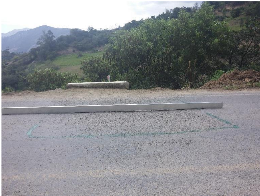
Figura 74: Unidad De Muestra - 27. Peladura De Severidad Media.
