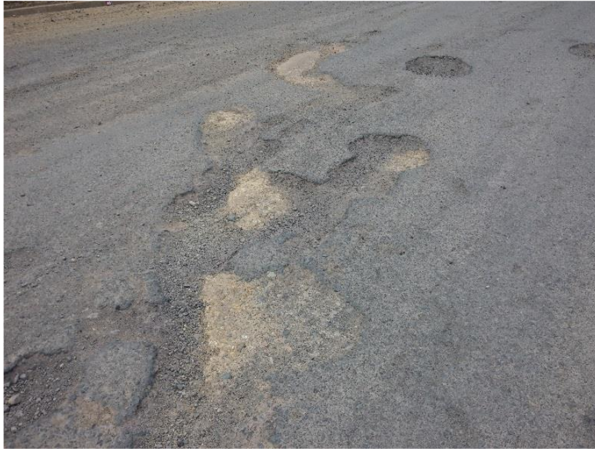
Figura 93: Unidad De Muestra - 46. Peladura Y Baches De Severidad Alta.
