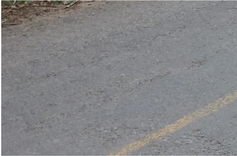
Figura 77: Unidad De Muestra - 30. Peladura De Severidad Baja.
