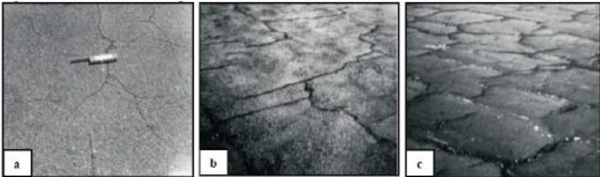
Figura 6: Fisuras En Bloque De Niveles De Severidad Bajo (a), Medio (b) y Alto (c). (Fuente: Rodríguez, 2009).
