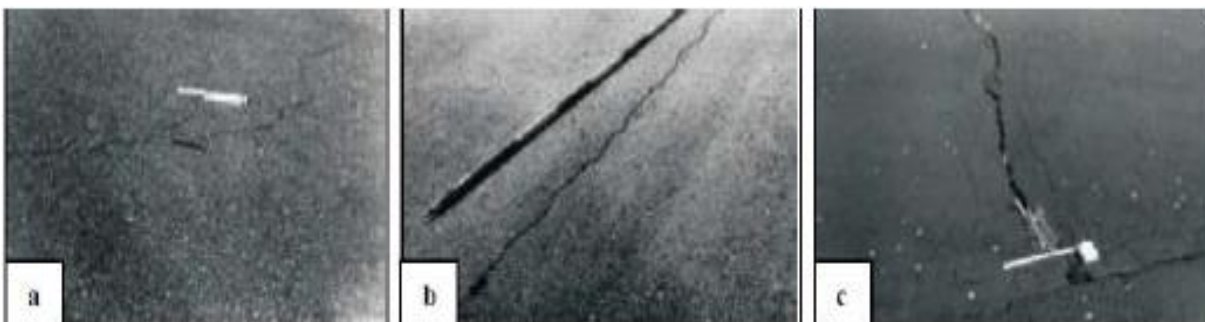
Figura 13: Fisuras Longitudinales Y Transversales, Nivel De Severidad Bajo (a), Medio (b) y Alto (c). (Fuente: Rodríguez, 2009).
