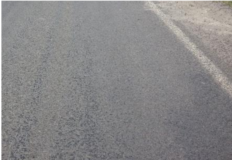
Figura 95: Unidad De Muestra - 48. Peladura De Severidad Baja.
