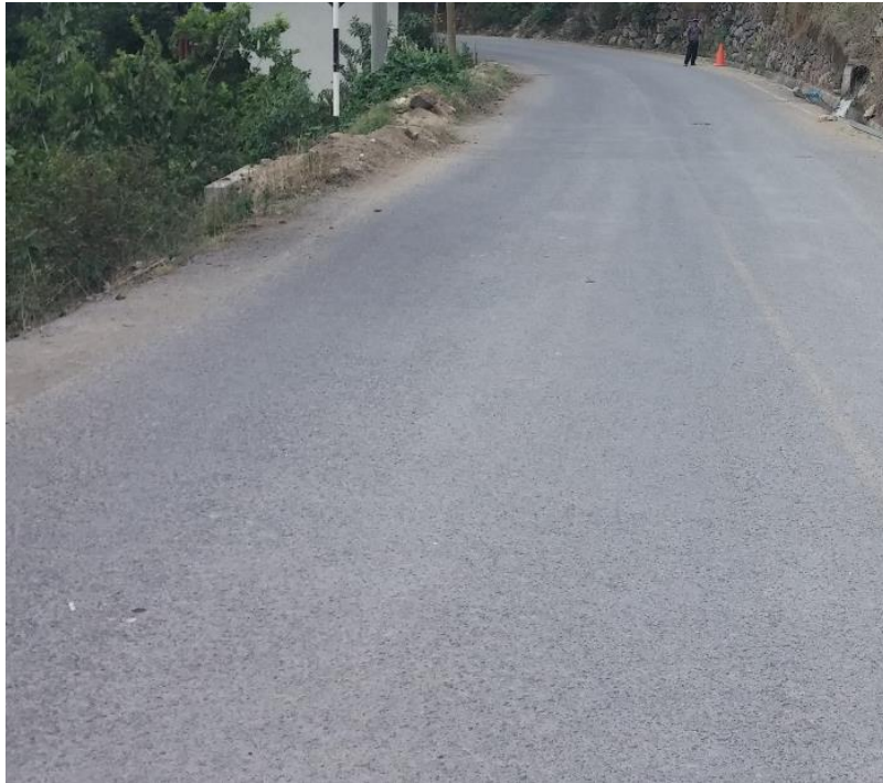
Figura 69: Unidad De Muestra - 22. Peladura De Severidad Baja.
