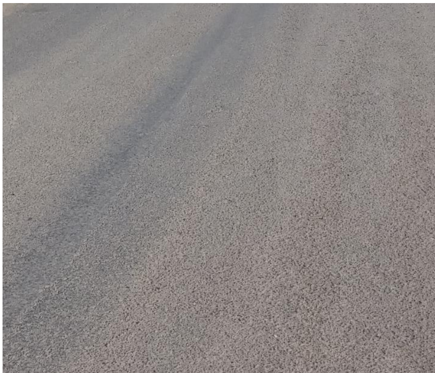
Figura 94: Unidad De Muestra - 47. Exudación Y Peladura De Severidad Baja.
