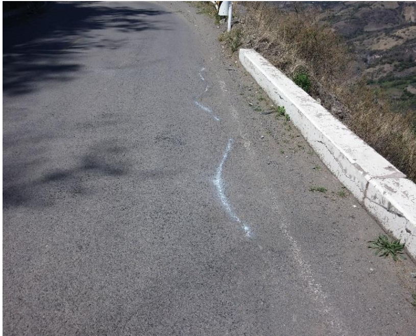
Figura 49: Unidad De Muestra - 02. Fisura De Borde De Severidad Media.
