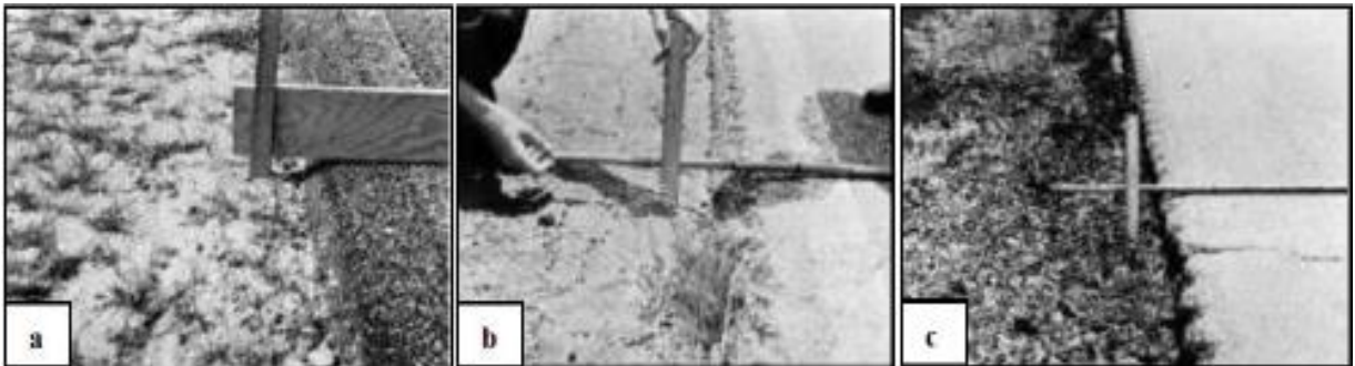
Figura 12: Desnivel Carril - Berma De Nivel De Severidad Bajo (a), Medio (b) y Alto (c). (Fuente: Rodríguez, 2009).
