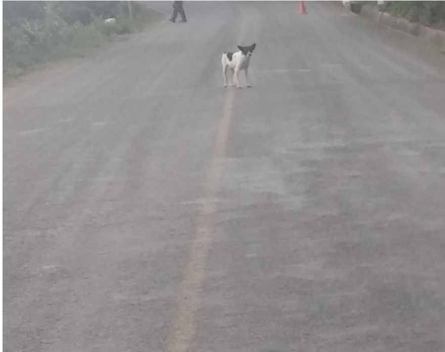
Figura 71: Unidad De Muestra - 24. Ahuellamiento De Severidad Baja.
