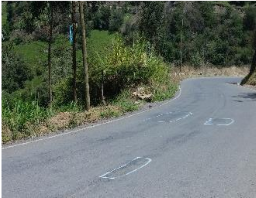
Figura 53: Unidad De Muestra - 06. Exudación De Severidad Baja.
