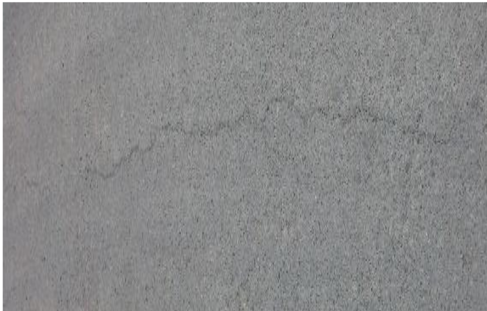
Figura 76: Unidad De Muestra - 29. Fisuras De Borde De Severidad Media.
