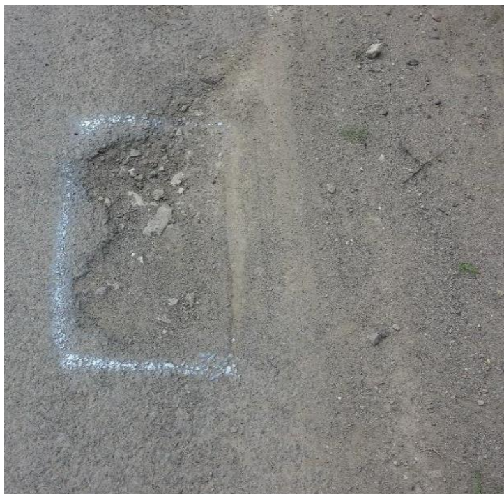
Figura 55: Unidad De Muestra - 08. Fisura De Borde De Severidad Baja Y Hundimientos De Severidad Media.
