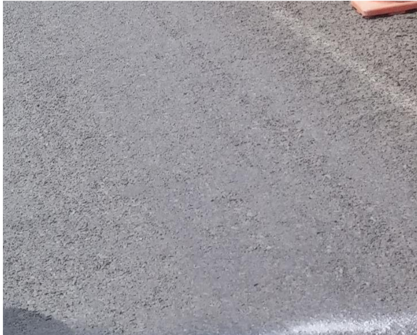
Figura 79: Unidad De Muestra - 32. Peladura De Severidad Baja.
