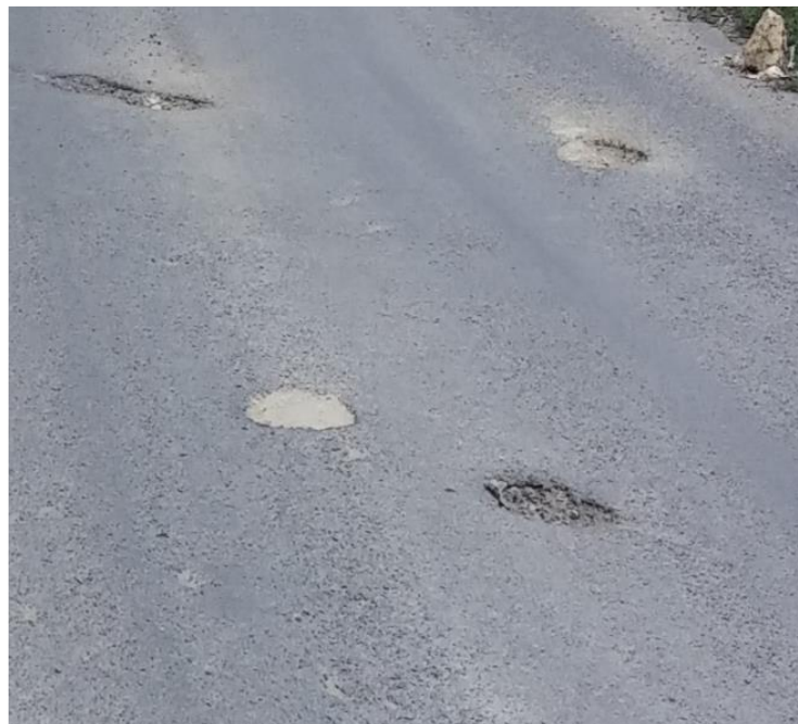
Figura 86: Unidad De Muestra - 39. Baches De Severidad Media.
