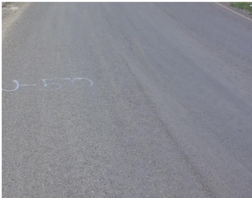
Figura 97: Unidad De Muestra - 50. Peladura De Severidad Baja.
