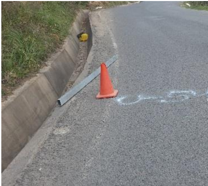
Figura 101: Unidad De Muestra - 54. Estado De Pavimento De Severidad Baja.
