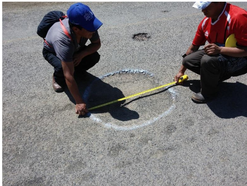
Figura 50: Unidad De Muestra - 03. Baches De Severidad Media Y Alta.
