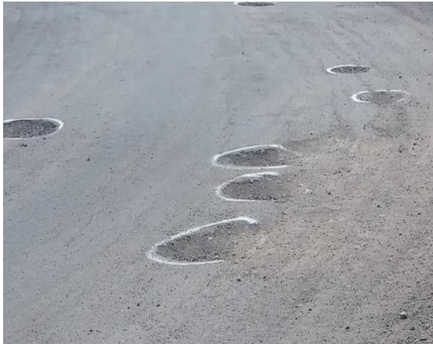
Figura 80: Unidad De Muestra - 33. Baches De Severidad Alta.
