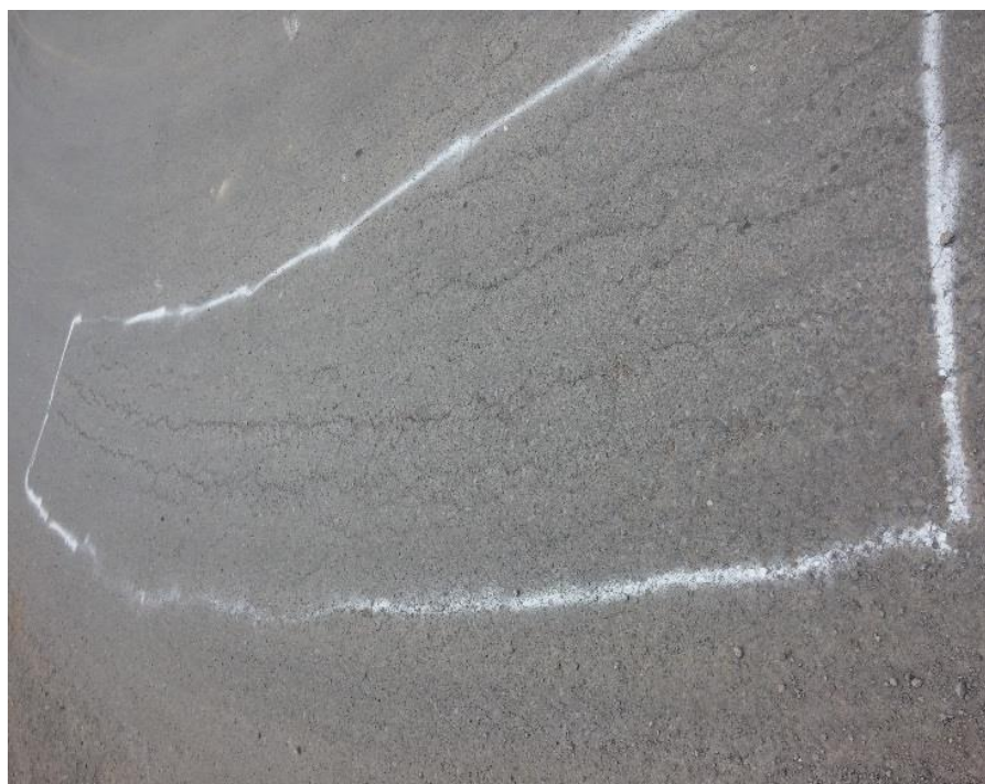
Figura 82: Unidad De Muestra - 35. Peladura De Severidad Baja.
