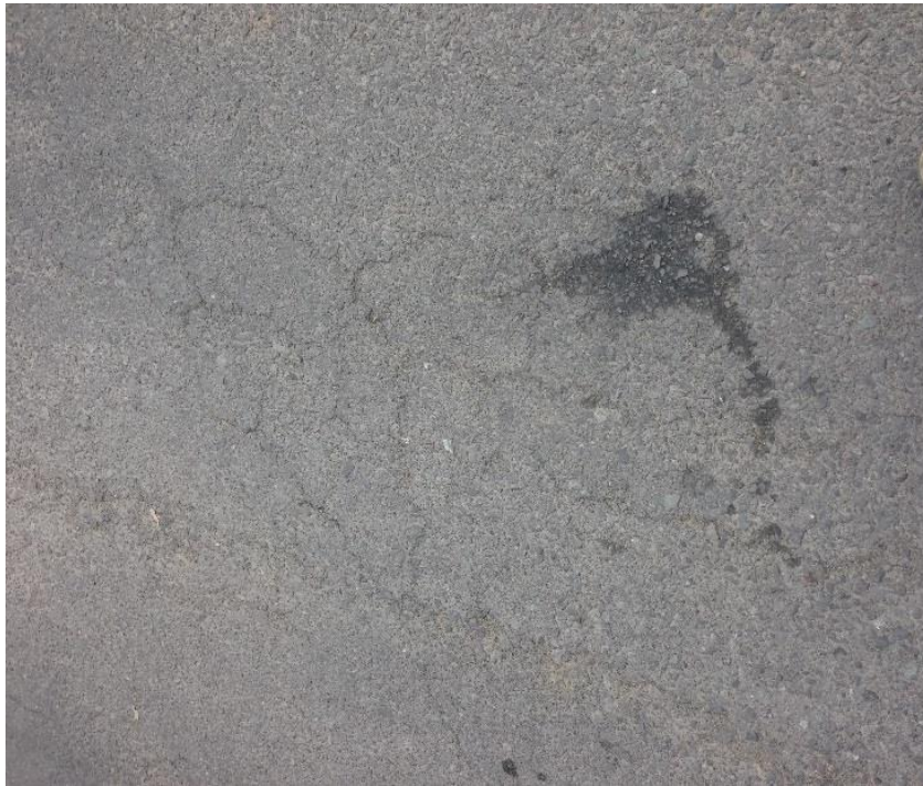
Figura 87: Unidad De Muestra - 40. Piel de cocodrilo de severidad baja.
