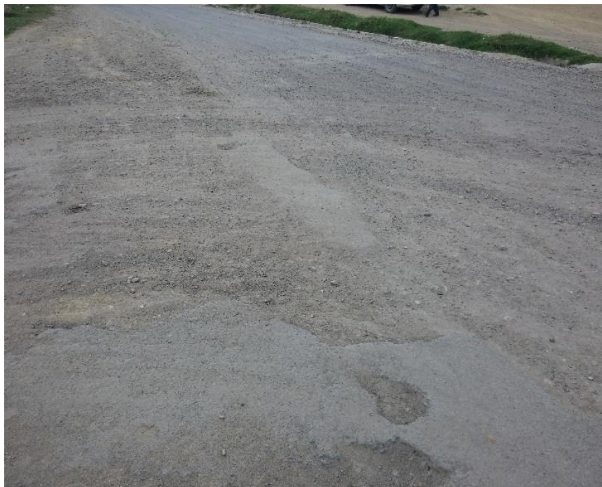
Figura 103: Unidad De Muestra - 56. Estado De Pavimento Muy Malo.
