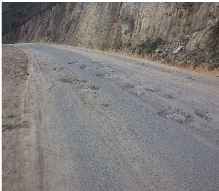
Figura 98: Unidad De Muestra - 51. Estado De Pavimento Malo.
