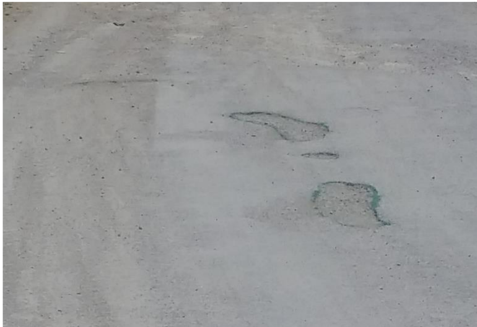
Figura 66: Unidad De Muestra - 19. Baches De Severidad Alta.
