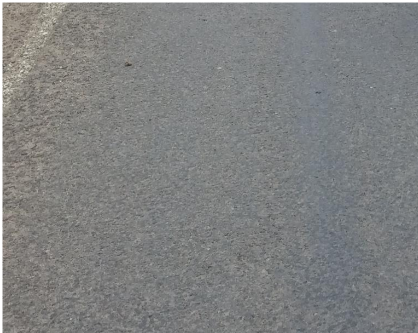
Figura 89: Unidad De Muestra - 42. Peladura De Severidad Baja.
