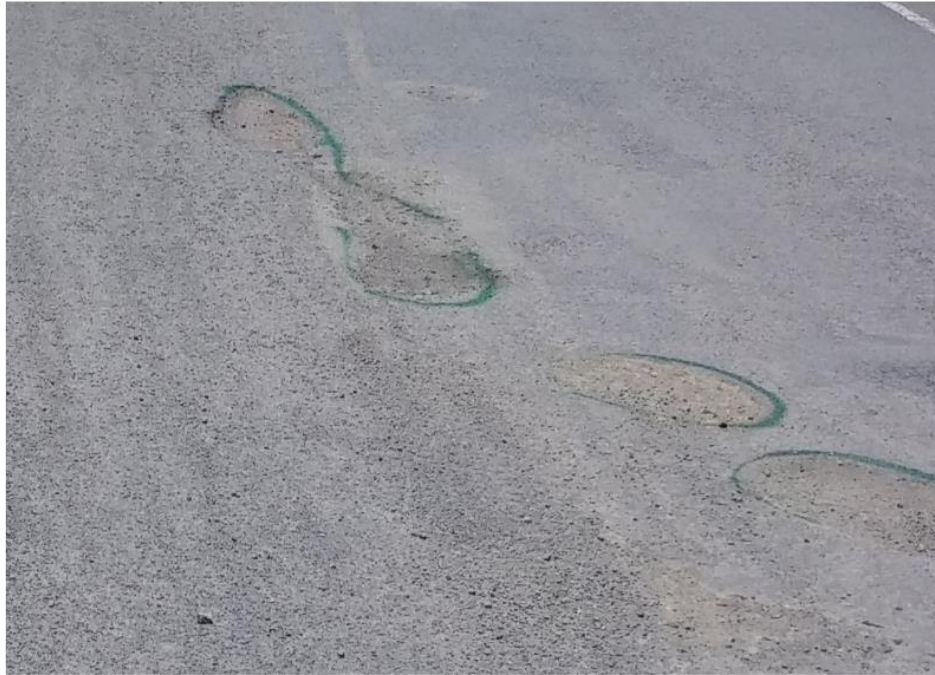
Figura 59: Unidad De Muestra - 10. Baches De Severidad Alta.
