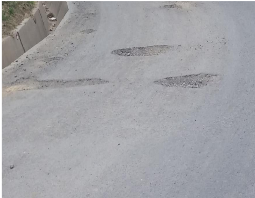
Figura 92: Unidad De Muestra - 45. Baches De Severidad Alta.
