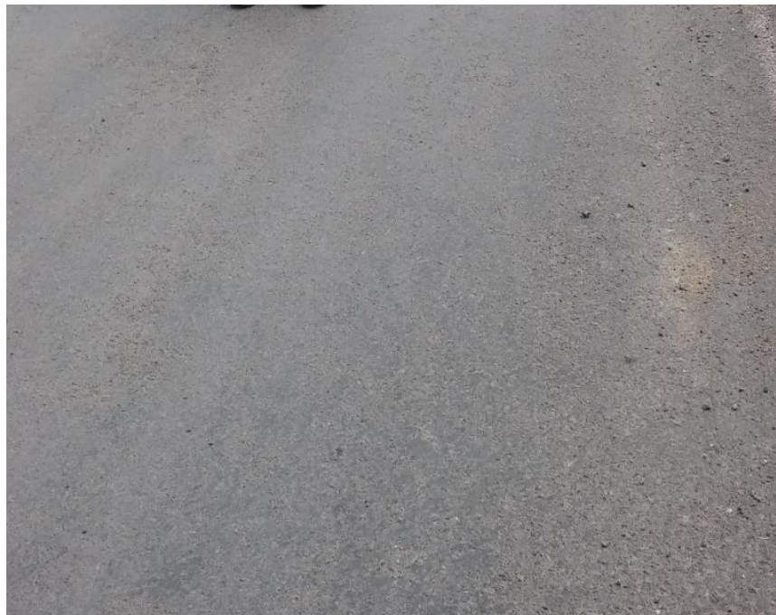
Figura 88: Unidad De Muestra - 41. Peladura De Severidad Baja.
