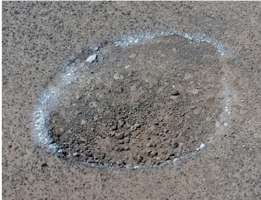
Figura 73: Unidad De Muestra - 26. Baches De Severidad Alta.
