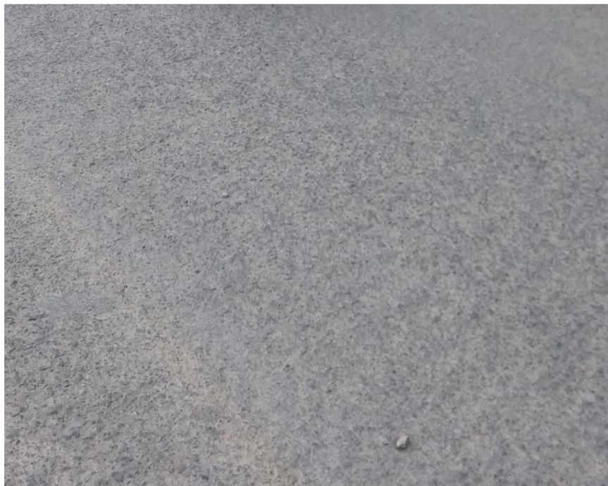
Figura 70: Unidad De Muestra - 23. Peladura De Severidad Media.
