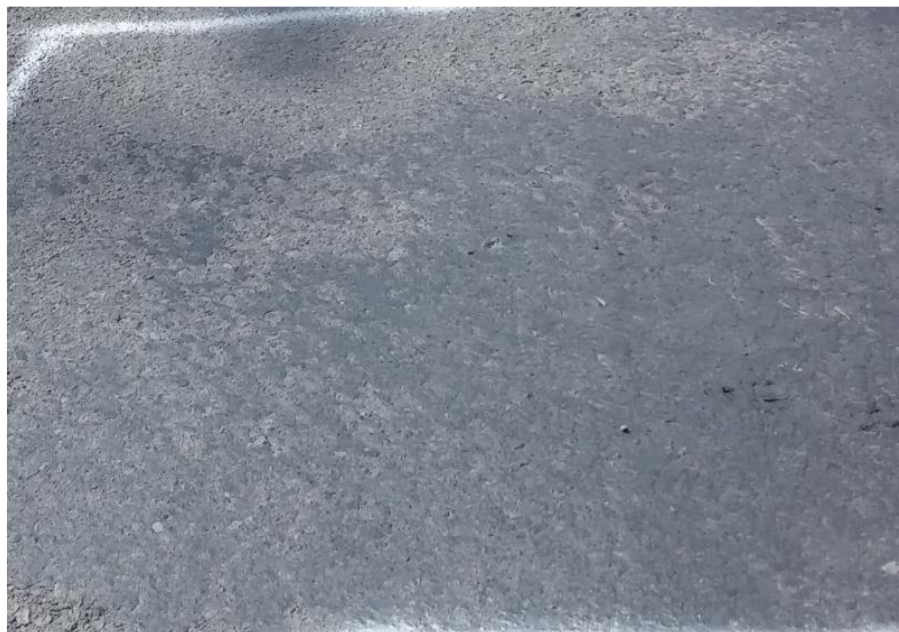
Figura 81: Unidad De Muestra - 34. Peladura De Severidad Baja.
