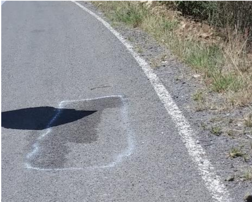
Figura 51: Unidad De Muestra - 04. Exudación De Severidad Baja.
