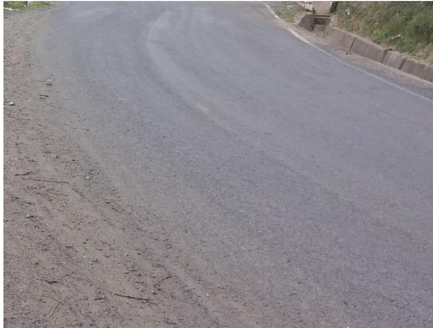
Figura 91: Unidad De Muestra - 44. Peladura De Severidad Baja.
