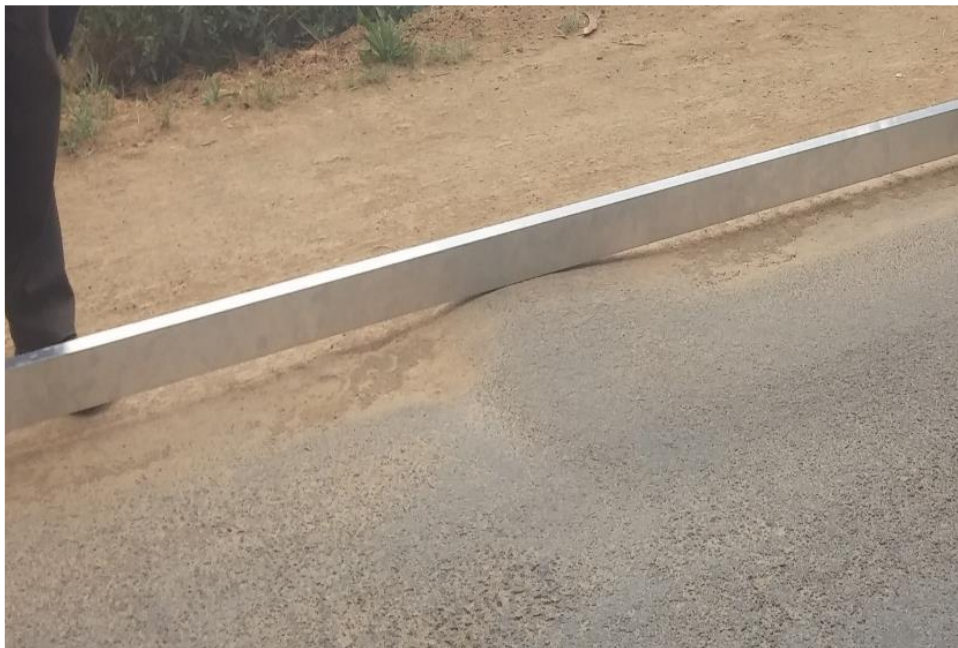
Figura 72: Unidad De Muestra - 25. Ahuellamiento Y Hundimientos De Severidad Media.
