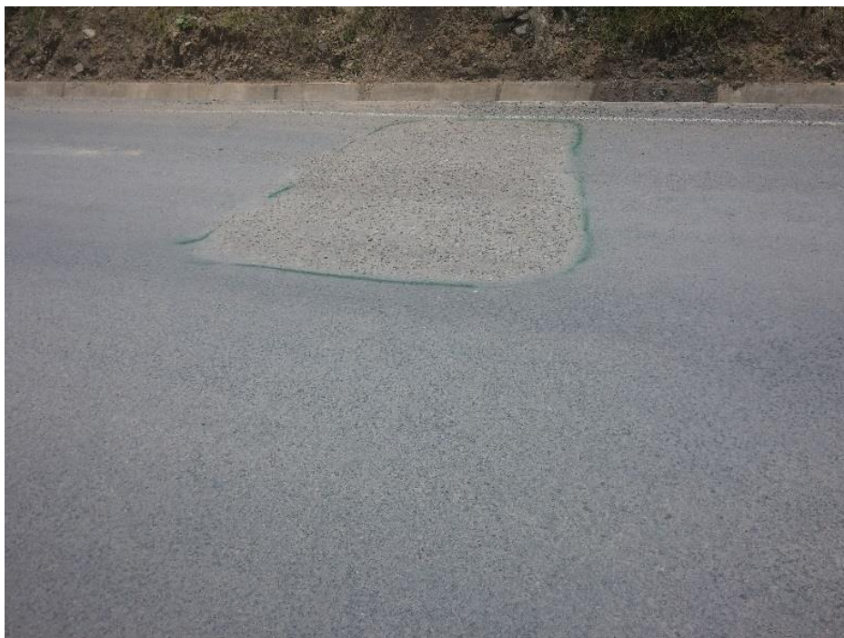
Figura 61: Unidad De Muestra - 14. Peladura de severidad alta.
