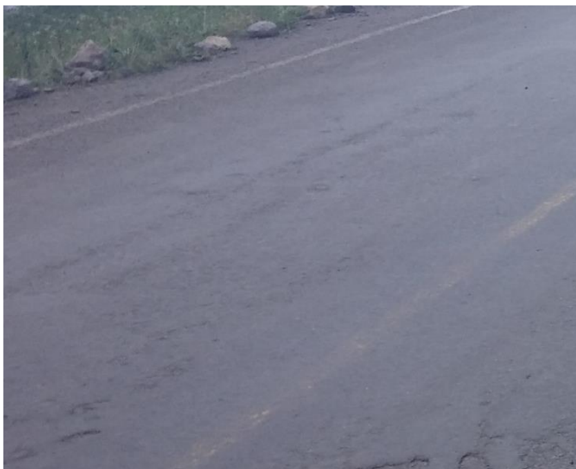
Figura 68: Unidad De Muestra - 21. Peladura De Severidad Baja.
