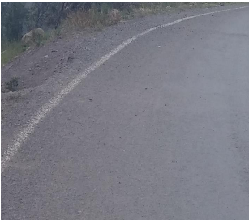
Figura 67: Unidad De Muestra - 20. Peladura De Severidad Baja.
