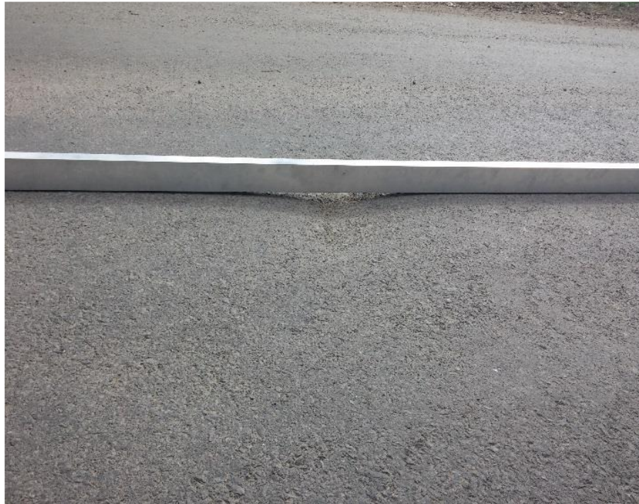
Figura 83: Unidad De Muestra - 36. Ahuellamiento De Severidad Baja.
