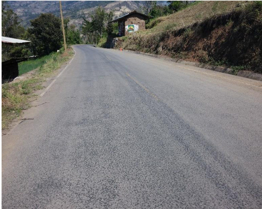
Figura 48: Unidad De Muestra - 01. Peladura De Grado De Severidad Bajo Y Medio.
