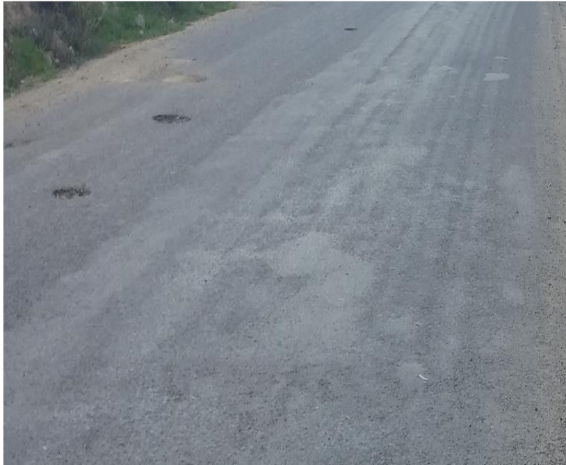
Figura 99: Unidad De Muestra - 52. Baches De Alta Severidad.
