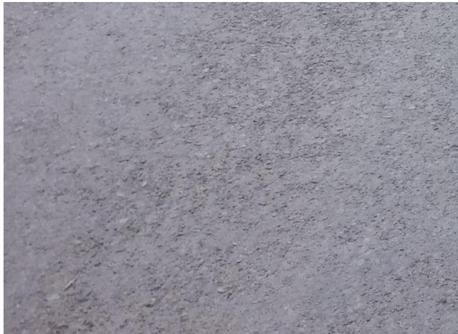
Figura 84: Unidad De Muestra - 37. Peladura De Severidad Baja.
