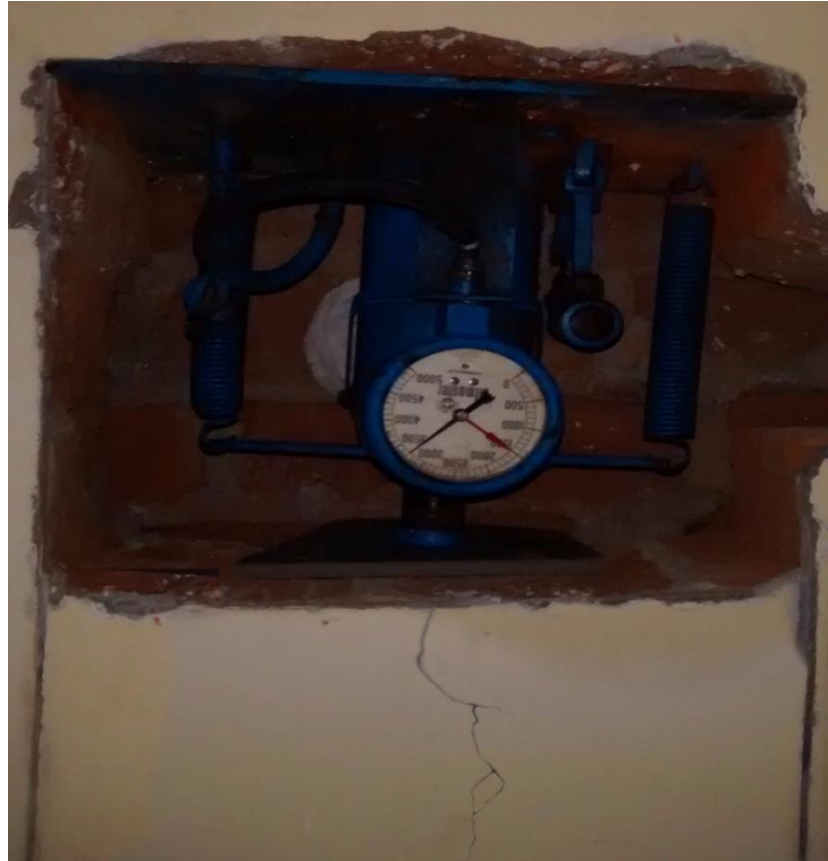
Foto 16: Momento de falla a compresión del muro de albañilería existente.
