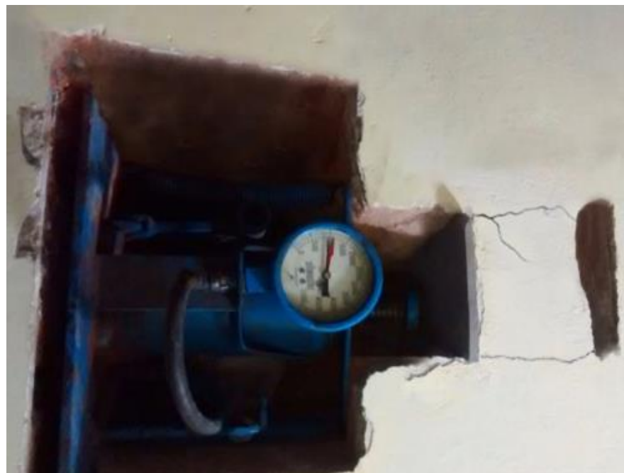
Foto 17: Momento de falla por corte del muro de albañilería existente.
