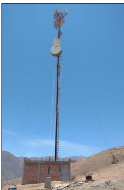
Figura 9. Torre Arriostrada con cables de vientos – Greenfield. Fuente propia.
