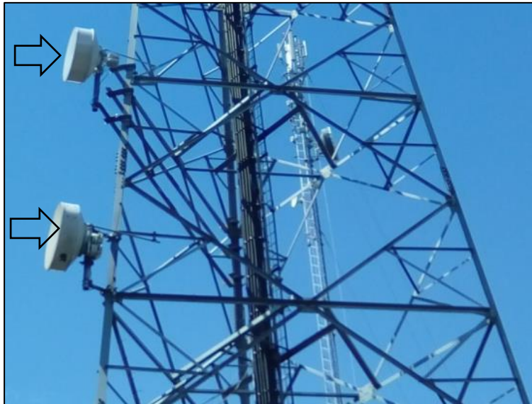
Figura 6. Soportes de antenas Crosspolar o Soporte a Montante. Fuente propia.
