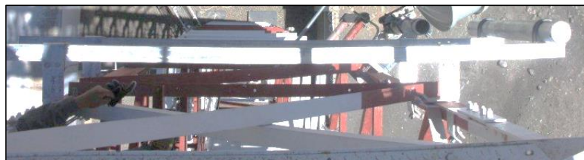
Figura 5. Soporte de antenas Minilink o Soporte a cara. Fuente propia.
