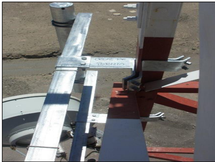
Figura 32. Soporte a cara Instalado en Torre Autosoportada. Fuente propia.
