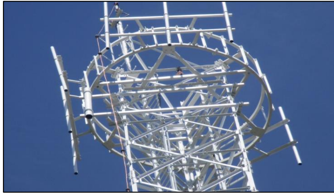
Figura 31. Roldana Metálica Instalada en parte superior de torre autosoportada. Fuente propia.
