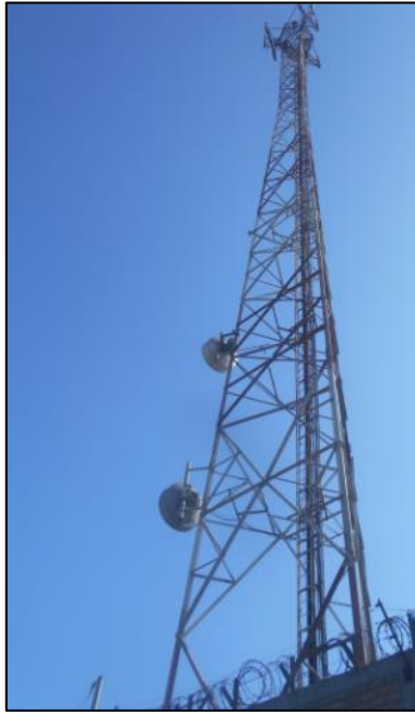
Figura 14. Torre Autoportada – Sección Triangular - Greenfield. Fuente propia.
