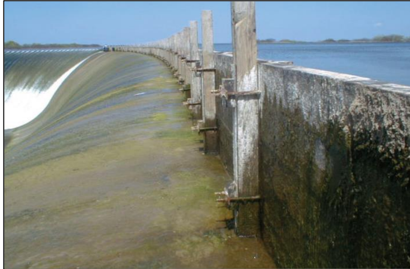
Figura 3. Agujas instaladas en la presa Marte R. Gómez, Tamaulipas, México
