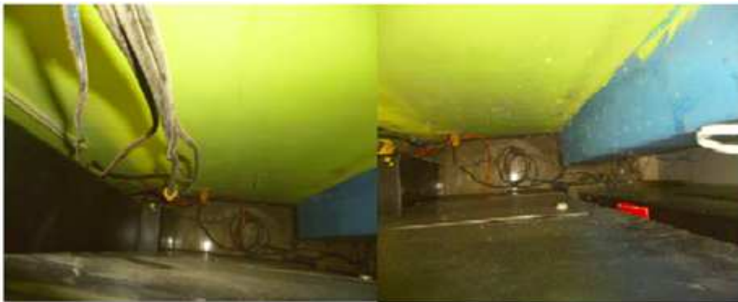
Figura 3.15: Cable data Power 12v con alimentacion domestica
