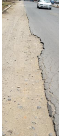
Ilustración 31 - Fisura de borde
