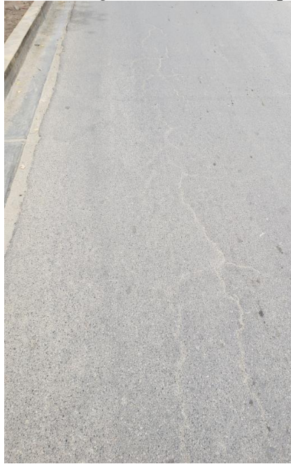
Ilustración 13- Agrietamiento en bloque (AB)
