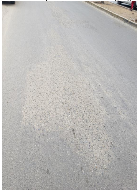
Ilustración 12 - Desprendimiento de agregados (PA)
