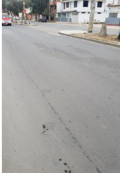
Ilustración 29 - Perdida de agregados
