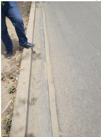
Ilustración 14 - Grieta de borde (GB)
