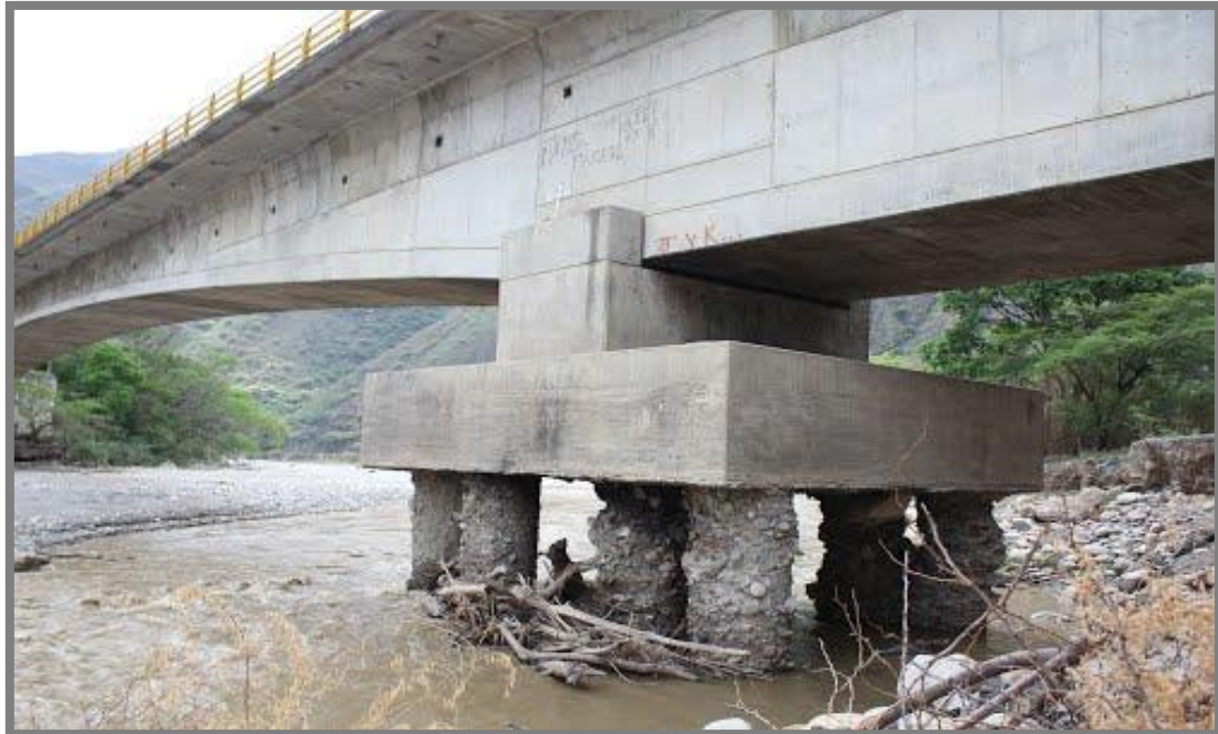
Imagen 7– Socavación en Pilar Puente Pescadero, Santander, Colombia. Fuente: (Castellanos Rangel, 2016, pág. 36)
