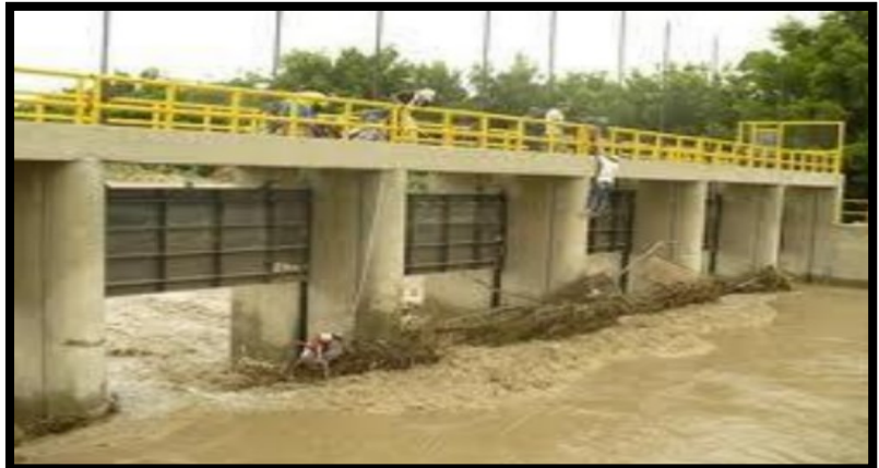
Figura 2: Barraje movil empleado en cauces de ríos
