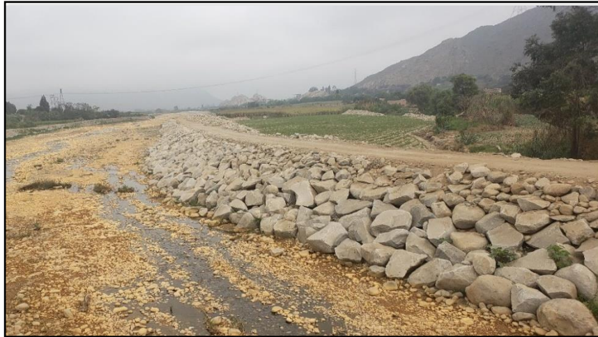
Figura 1 El Enrocado no tiene Uña de Protección contra el Volteo
