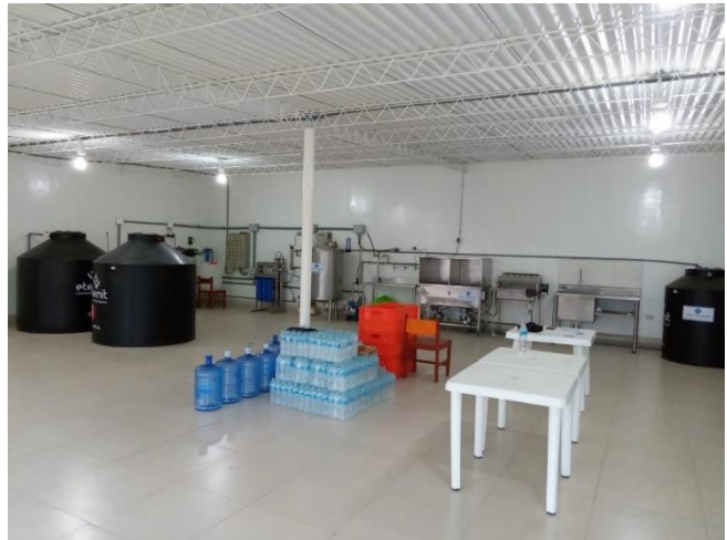
Interior de la planta de agua.
