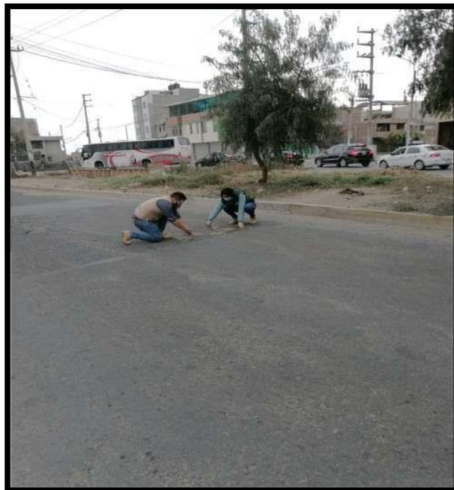
Foto n°6: De Vuelta de la Av. Micaela Bastidas hasta la Av. Mansiche – Falla n°13 (Huecos), Falla n°19 (Desprendimiento de Agregado) y Falla n°12 ( Pulimiento de Agregados)
