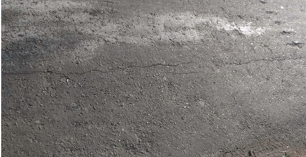
Imagen n° 4. Falla por agrietamiento longitudinal
