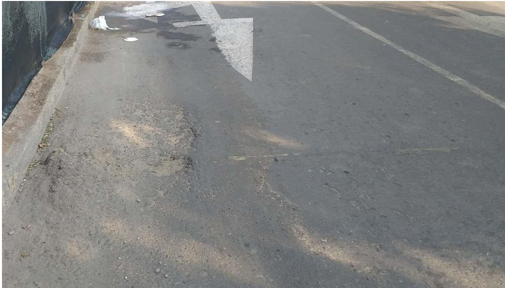
Imagen n° 2. Falla por ahuellamiento y ahuellamiento
