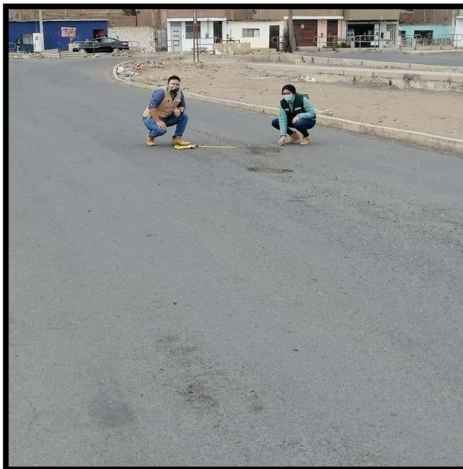
Foto n°4: De Vuelta de la Av. Micaela Bastida hasta la Av. Mansiche– Falla n°13 (Huecos), Falla n°19 (Desprendimiento de Agregado)
