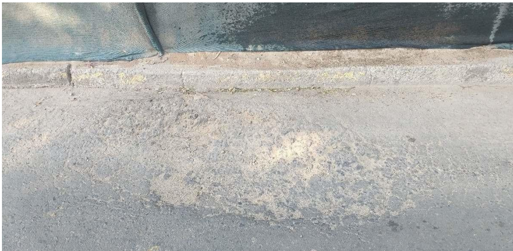
Imagen n° 3. Falla por desprendimiento y pulimiento de agregados
