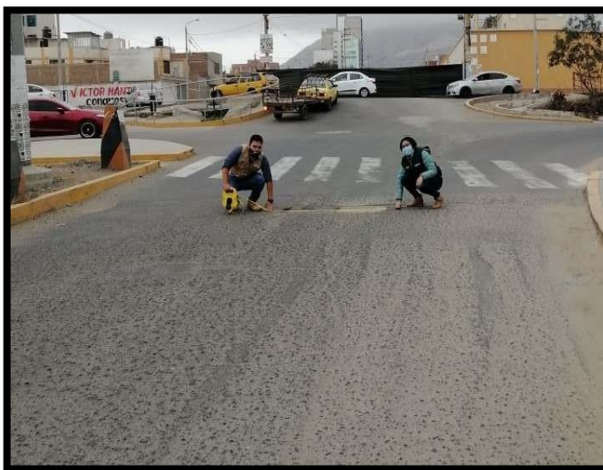
Foto n°2: De IDA de la Av. Mansiche hasta la Av. Micaela Bastidas – Falla n°13 (Huecos),
