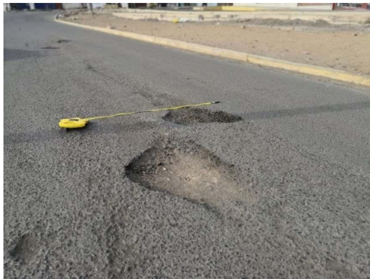
Imagen n° 5. – Huecos en la calzada – AV. Metropolitana II Fuente: Autoría propia
