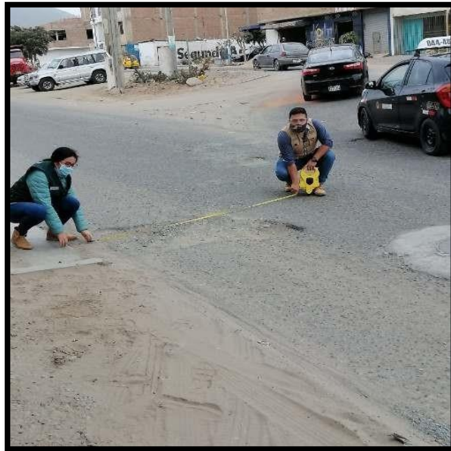
Foto n°5: De Vueltas de la Av. Micaela Bastidas hasta la Av. Mansiche – Falla n°13 (Huecos), Falla n°19 (Desprendimiento de Agregado).
