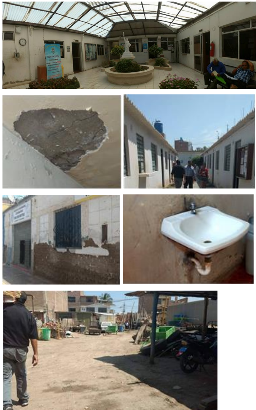
Figura N° 15: Deficiente Infraestructura Física de la MDLV
