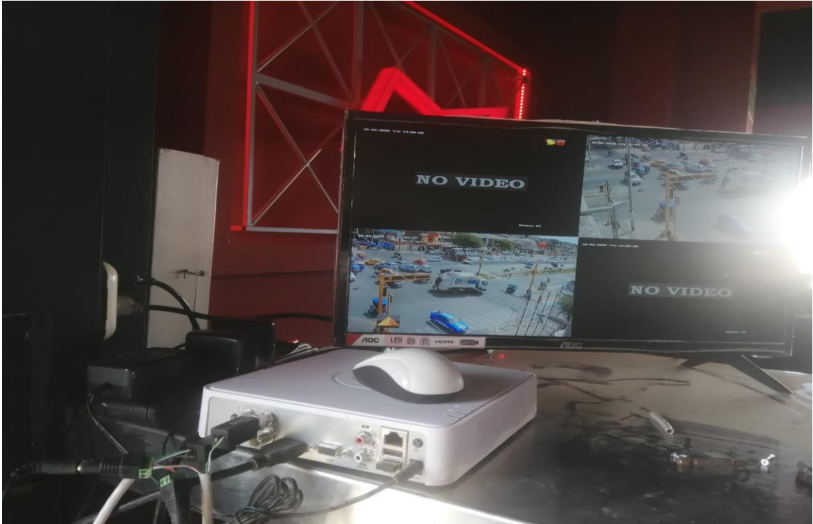
Foto N° 09: Monitoreo de funcionamiento de cámaras de video
