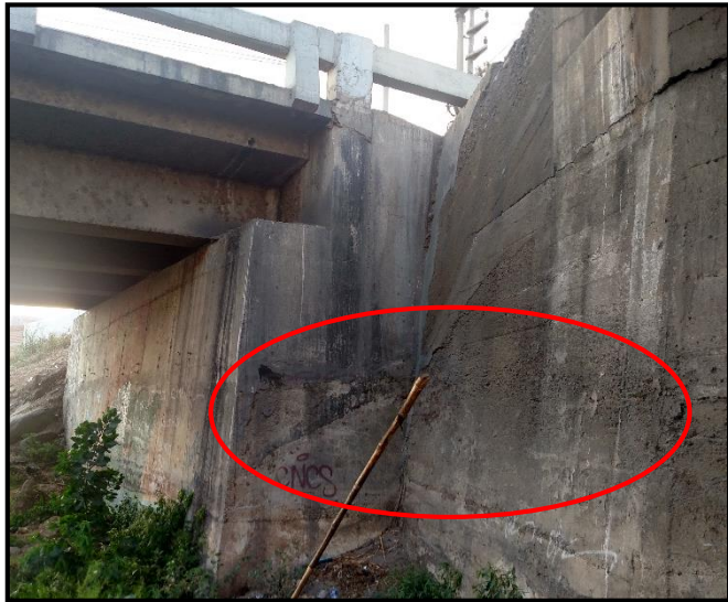
Figura N° 12. Presencia de grietas en el Estribo 1
