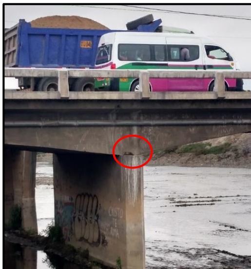
Figura N° 13. Presencia de grietas en el Pilar 1
