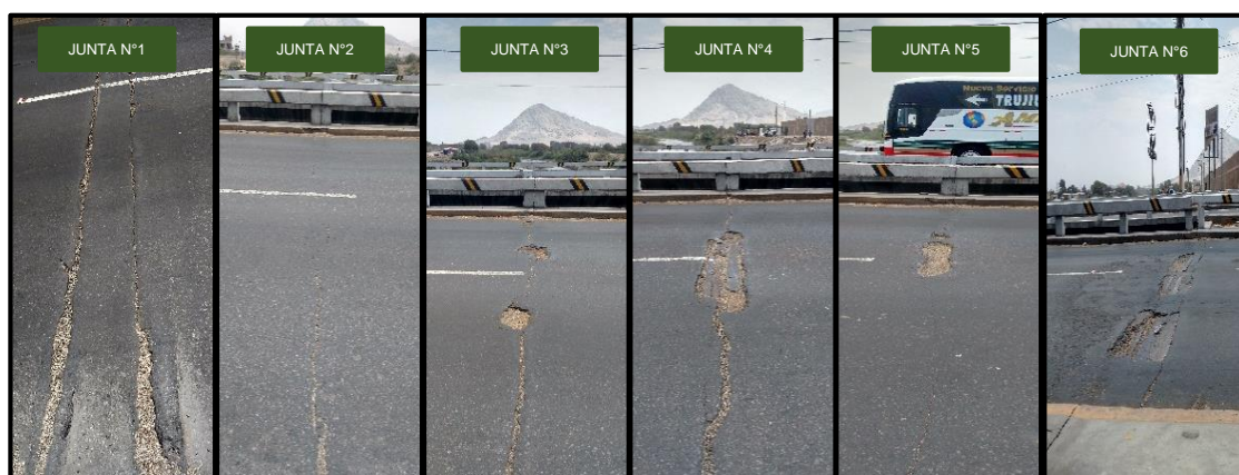
Figura N° 14. Juntas de dilatación actual
