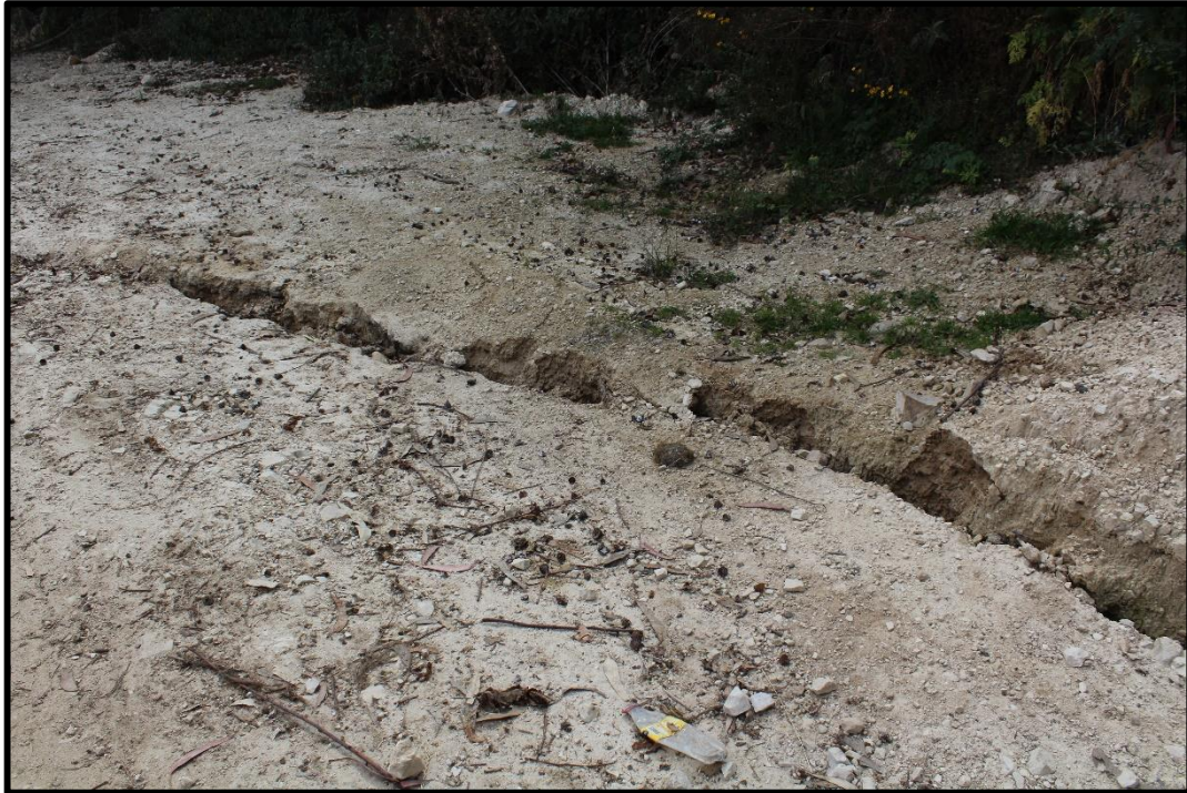
Figura 9.3: Asentamiento 3 y fisura al extremo de la carretera
