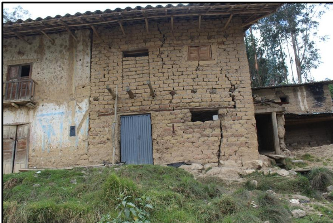
Figura 9.10: Fisuras en vivienda 2
