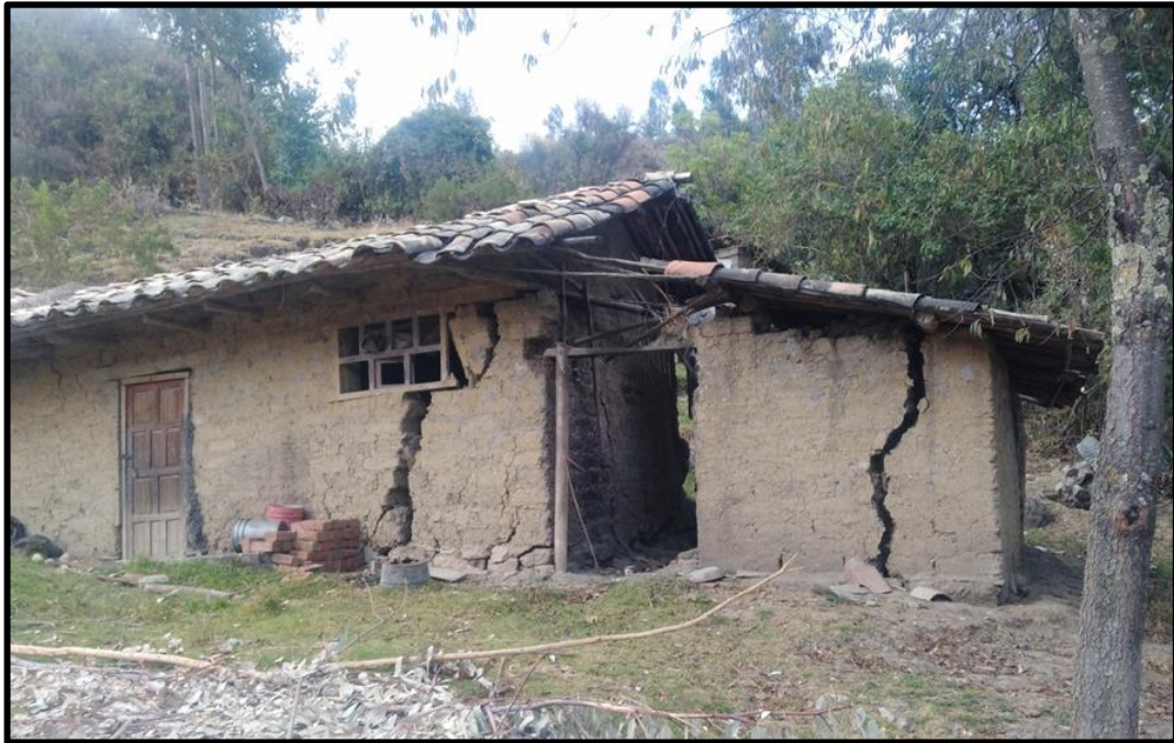
Figura 9.7: Fisuras en vivienda 1
