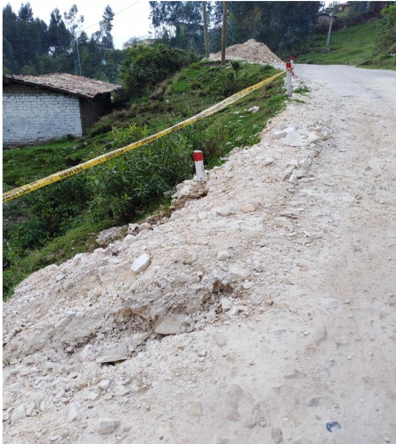
Figura 1.1: Asentamiento de la carretera
