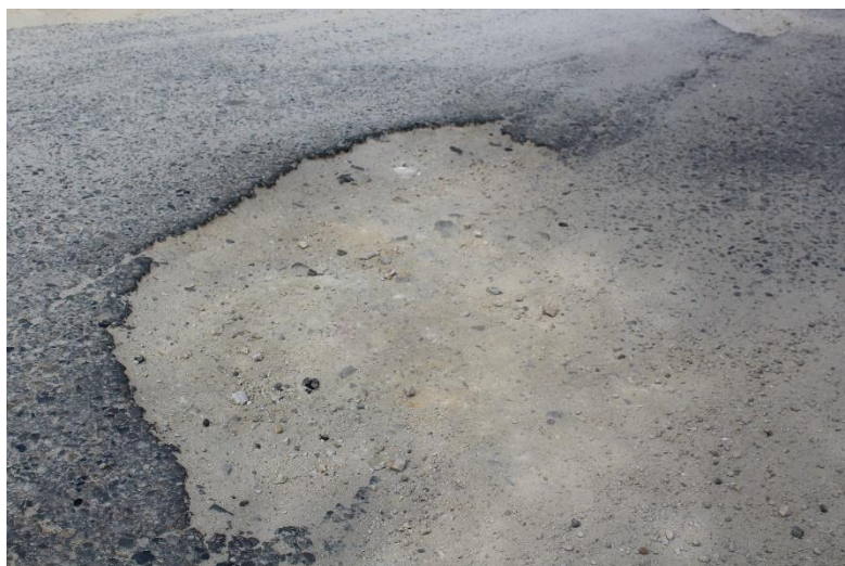
Figura 1.3: Asentamiento de la carretera
