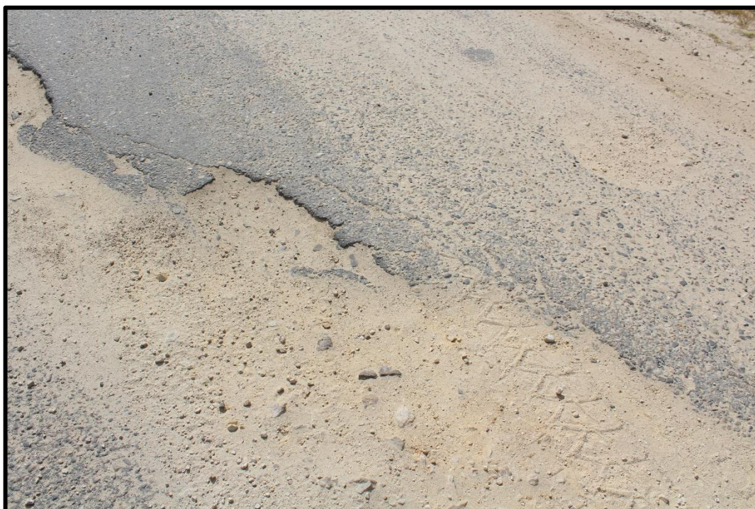
Figura 9.2: Asentamiento 2 de la carretera
