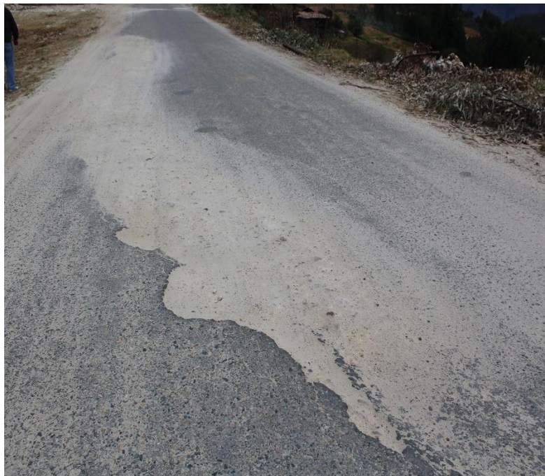
Figura 1.2: Asentamiento de la carretera
