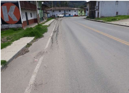
Nota. Km 87+875. Ahuellamiento con severidad alta. Zona más crítica del lado izquierdo.
