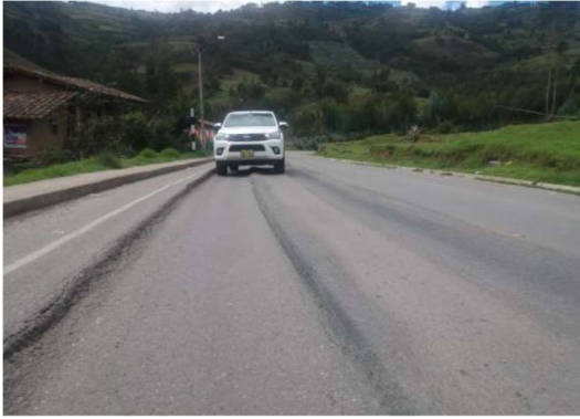
Nota. Km 88+050. Ahuellamiento con severidad alta. Zona más crítica del lado izquierdo.
