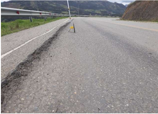
Nota. Km 84+600. Ahuellamiento con severidad alta.
