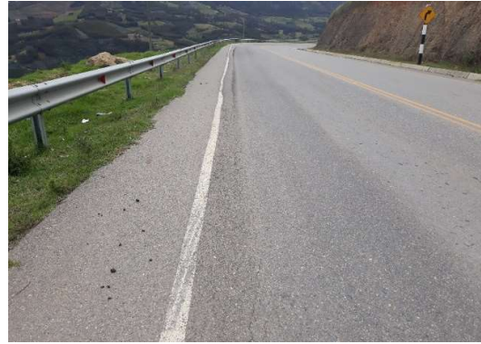
Nota. Km 84+650. Ahuellamiento con severidad alta y media.
