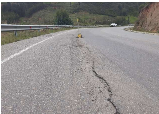
Nota. Km 85+350. Ahuellamiento con severidad alta, la carpeta en la cresta
