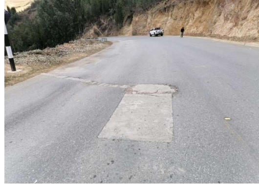
Nota. Km 83+476. Parche con losa de concreto hidráulico, severidad media y alta.
