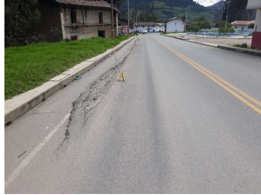
Nota. Km 87+810. Ahuellamiento con severidad alta. Zona más crítica del lado izquierdo.
