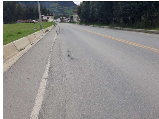
Nota. Km 87+650. Ahuellamiento con severidad alta. Zona más crítica del lado izquierdo.
