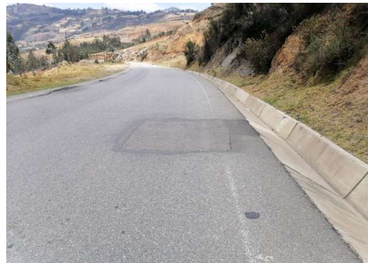
Nota. Km 84+821. Parchado de severidad media en el lado derecho.
