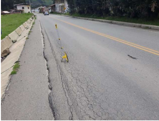
Nota. Km 87+700. Ahuellamiento con severidad alta. Zona más crítica del lado izquierdo.
