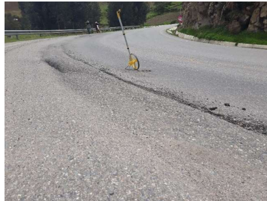
Nota. Km 84+050. Ahuellamiento con severidad alta, lado izquierdo.
