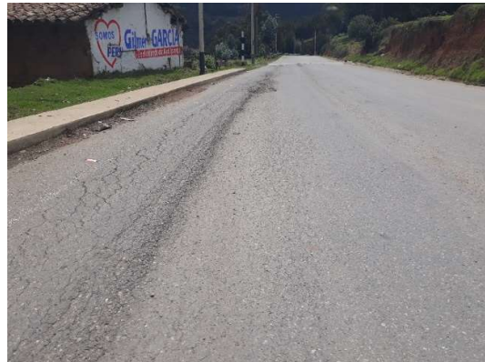
Nota. Km 88+950. Ahuellamiento con severidad alta y media.
