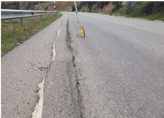
Nota. Km 84+750. Ahuellamiento con severidad alta.
