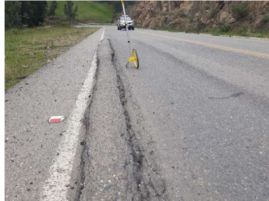
Nota. Km 85+775. Ahuellamiento con severidad alta.
