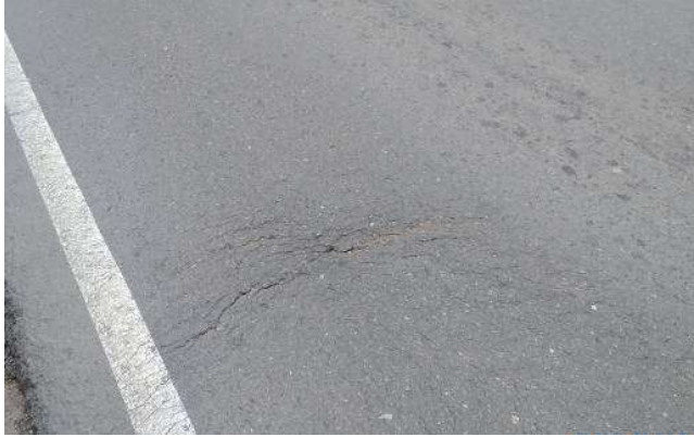
Figura 51 Grieta parabólica severidad media
