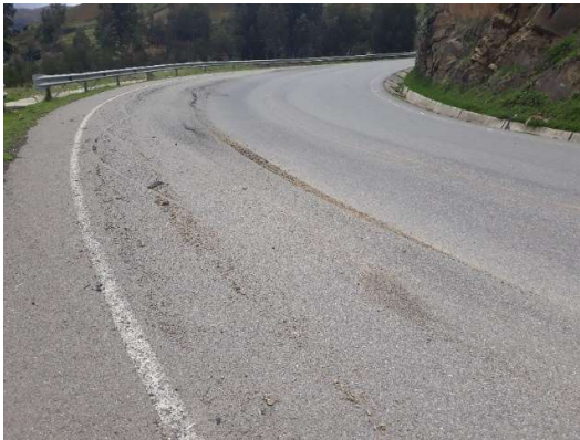
Nota. Km 84+000. Ahuellamiento con severidad alta, lado izquierdo.
