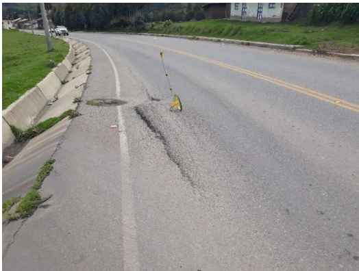
Nota. Km 87+550. Ahuellamiento con severidad alta y media. Inicia zona más crítica del lado izquierdo.
