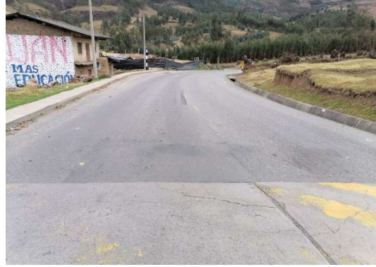
Nota. Km 88+143. Parche de severidad media pasando la giba.
