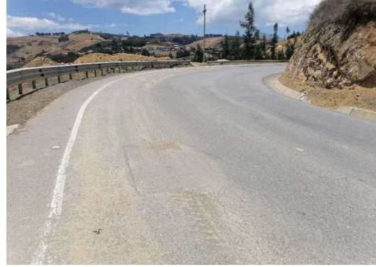
Nota. Km 81+721. Parchado con severidad media, y un continuo ahuellamiento de severidad media y alta.
