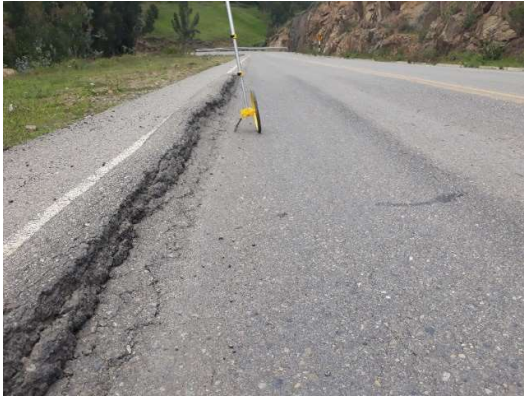
Nota. Km 85+775. Ahuellamiento con severidad alta.
