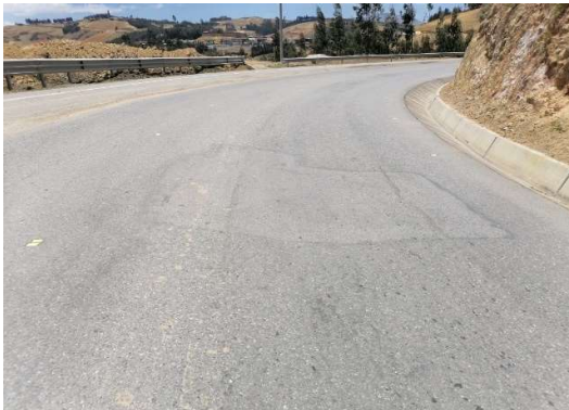
Nota. Km 81+730. Lado derecho, parchado de severidad media, con ahuellamiento leve.
