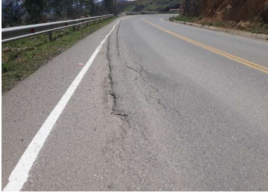
Nota. Km 81+668. Lado izquierdo con ahuellamiento de severidad alta, acompañado de piel de cocodrillo con severidad media.
