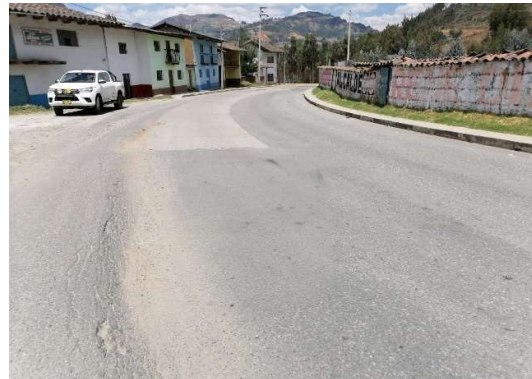
Nota. Km 87+920. Ahuellamiento con severidad alta y parche de concreto asfáltico con severidad media. Zona más crítica del lado izquierdo.
