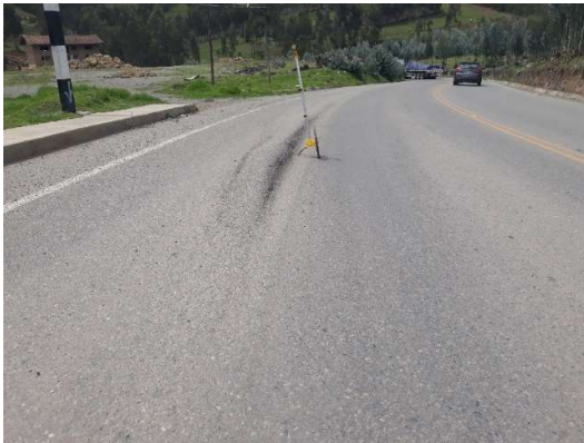
Nota. Km 88+200. Ahuellamiento con severidad alta y media.
