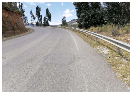
Nota. Km 85+409. Parchado con severidad media, además de
