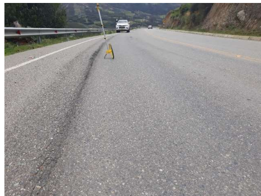
Nota. Km 84+550. Ahuellamiento con severidad alta y media, lado izquierdo.
