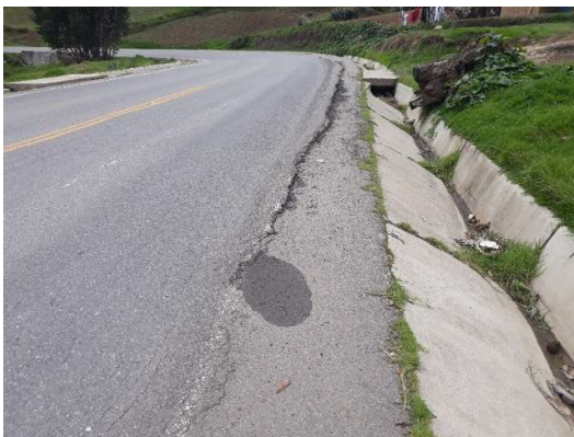
Nota. Km 84+130. Ahuellamiento en lado derecho, severidad alta.
