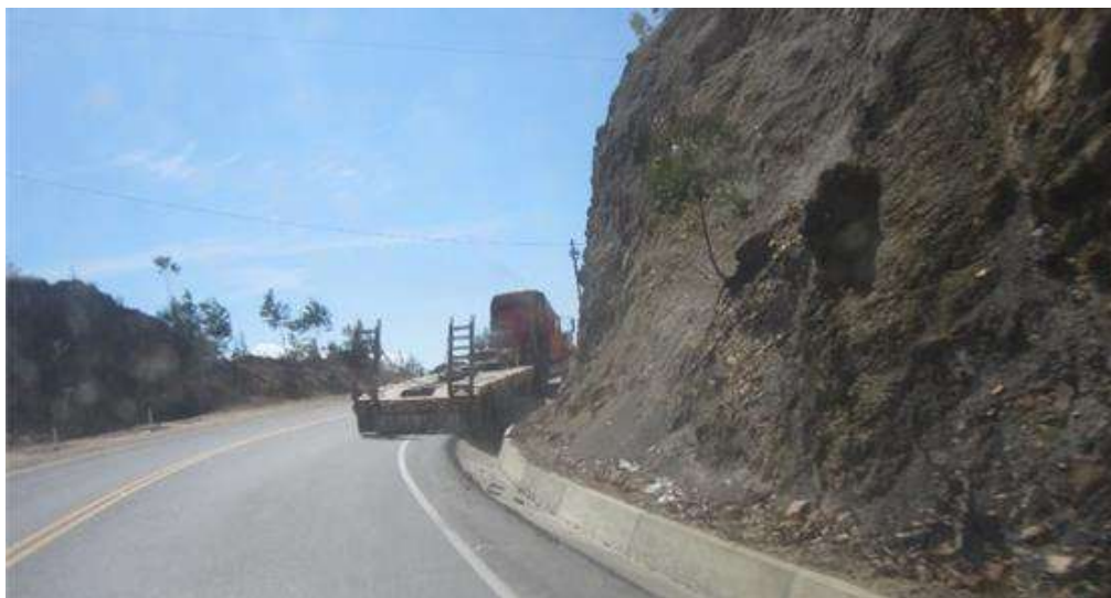
Figura N° 23: Falta del sobreebanco necesario en la curva
