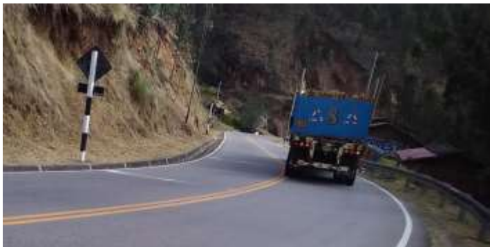
Figura N° 2: Falta de sobreechanco en las curvas
