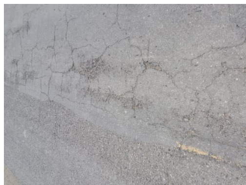
Figura N° 5 Falla: Agrietamiento longitudinal
