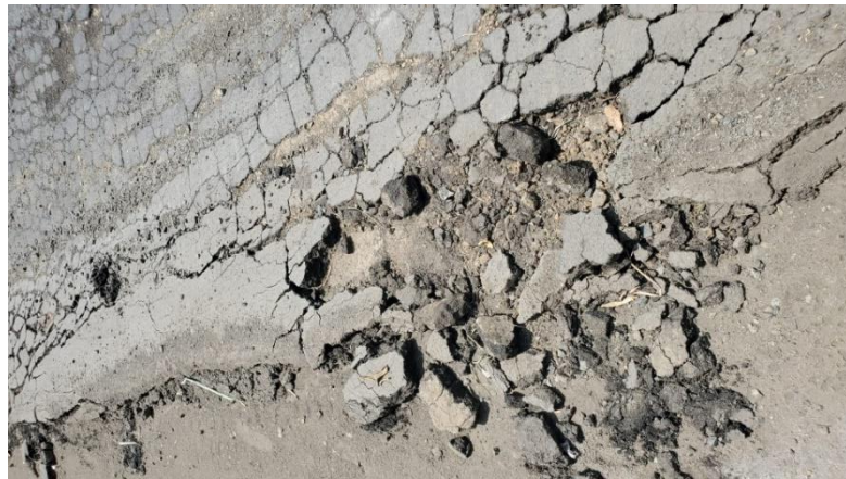
Figura N° 4 Falla: Tipo piel de cocodrilo y por desprendimiento
