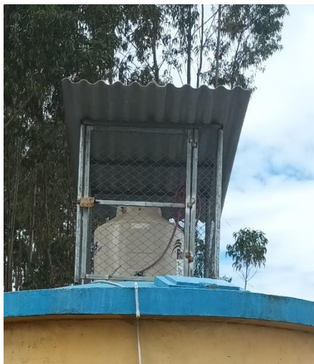
Imagen 07: Planta de tratamiento.
