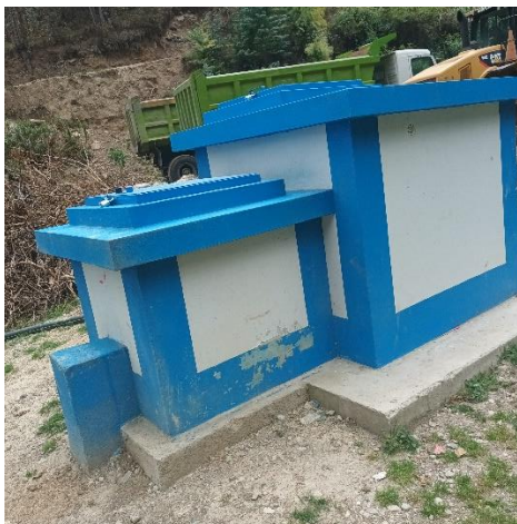
Imagen 09: Cámara rompe presión CRP-7
