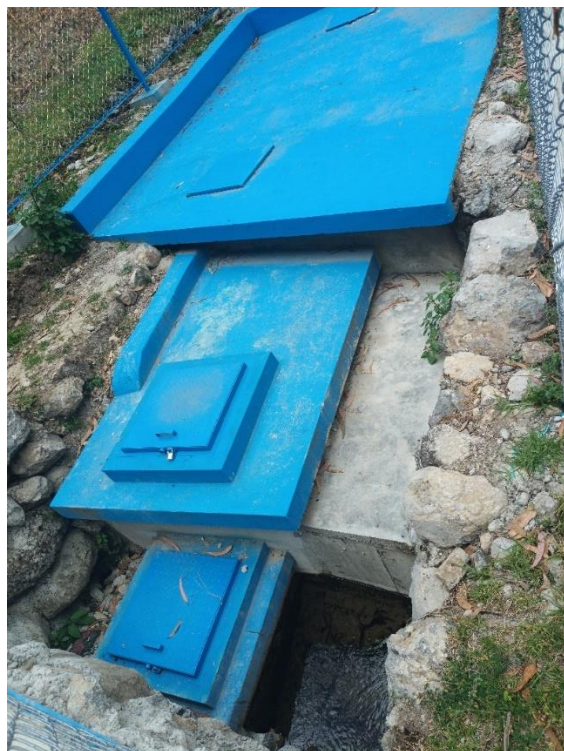
Imagen 02: Captación El Jaboncillo
