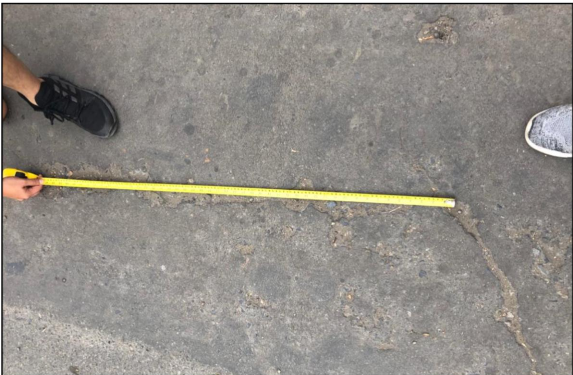
Fotografía 02: Se observa el mal estado del pavimento, daño en la capa de rodadura (grieta longitudinal).
