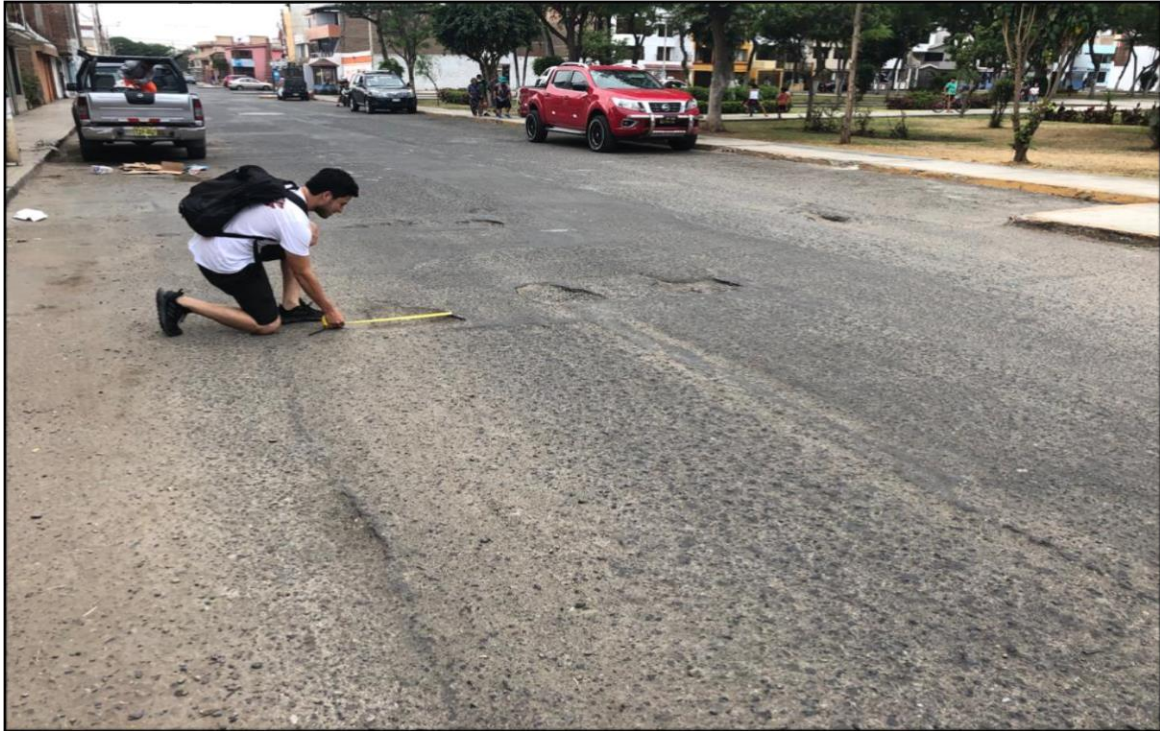
Fotografía 05: Se observa el mal estado del pavimento, daño en la capa de rodadura (parches y huecos)
