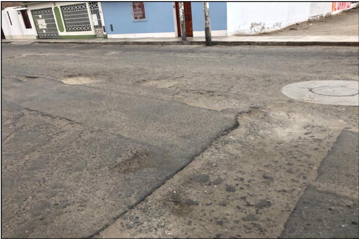
Fotografía 06: Se observa el mal estado del pavimento, daño en la capa de rodadura (parches y huecos)
