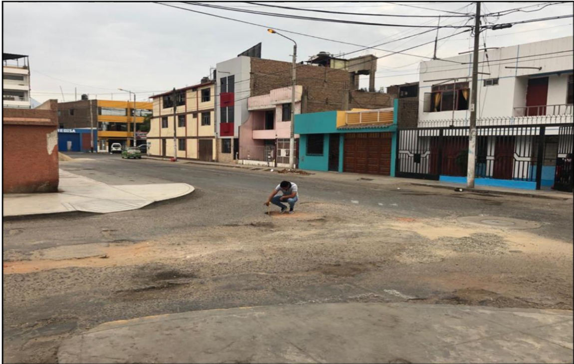
Fotografía 03: Se observa el mal estado del pavimento, daño en la capa de rodadura (grietas longitudinales, huecos y parches).
