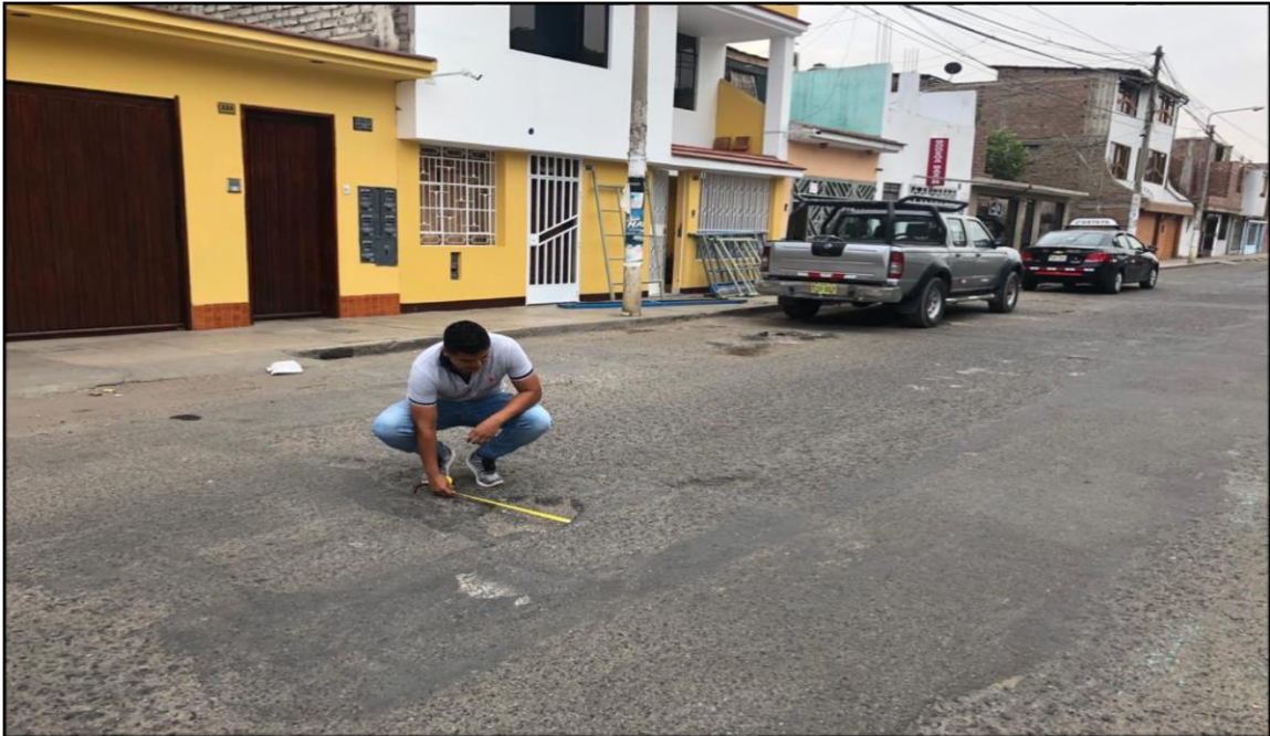
Fotografía 01: Se observa el mal estado del pavimento, daño en la capa de rodadura (huecos).
