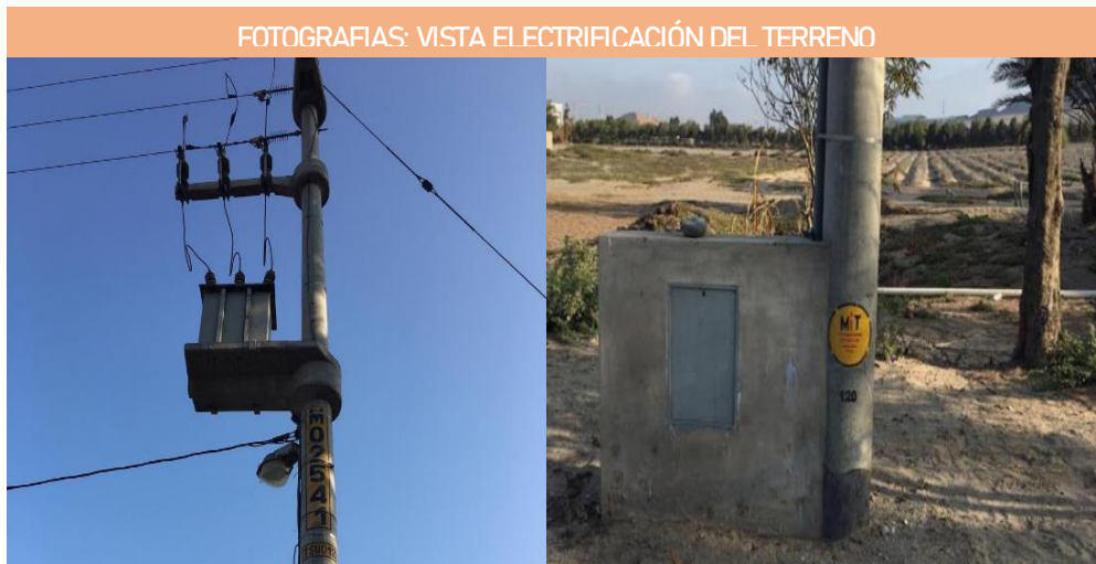
Imagen N° 58: Vista electrificación del terreno
