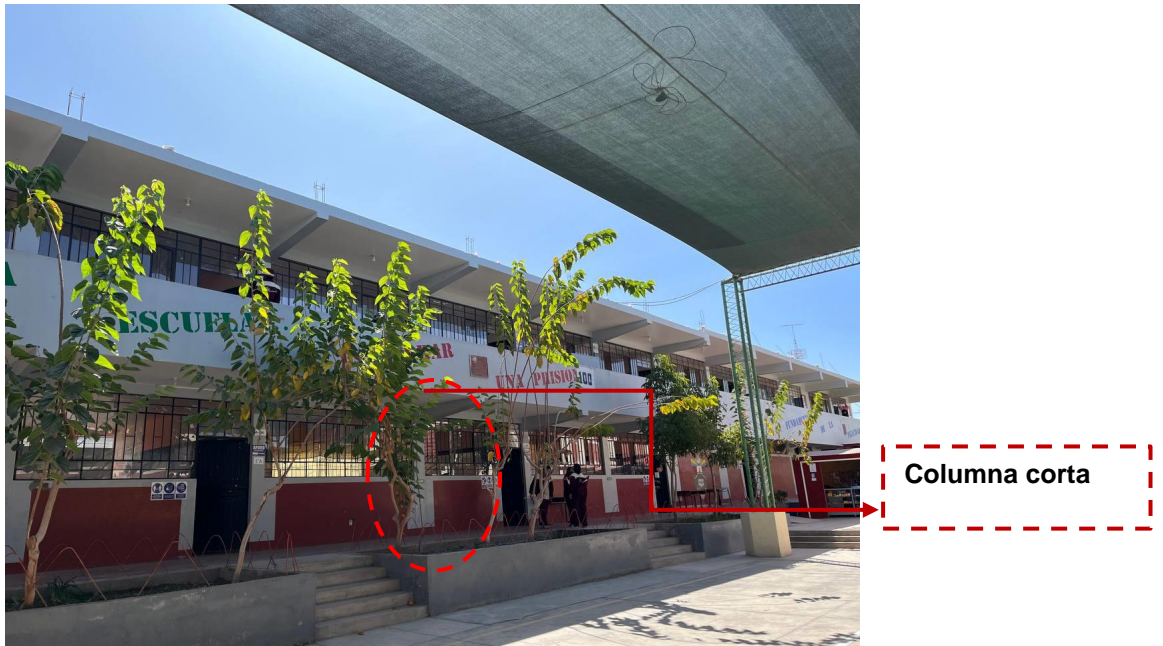
Figura 72 Columna corta en bloque 2 (vista frontal) Fuente: Propia
