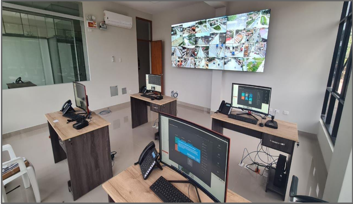
Sistema de Video Wall Finalizado
