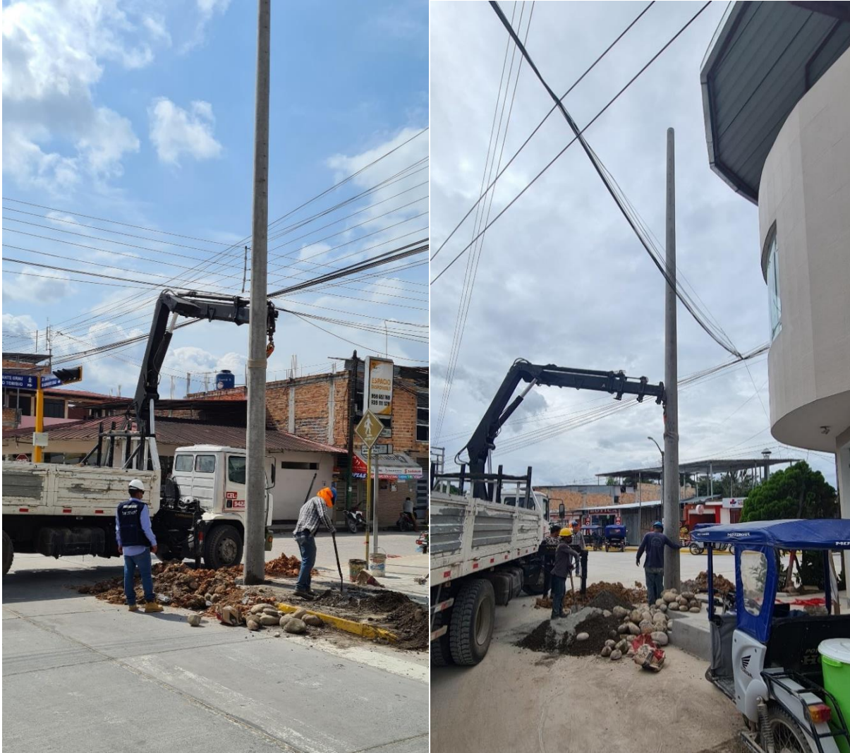
Instalación de Postes de 13 Metros en el Centro de la Ciudad de Rioja
