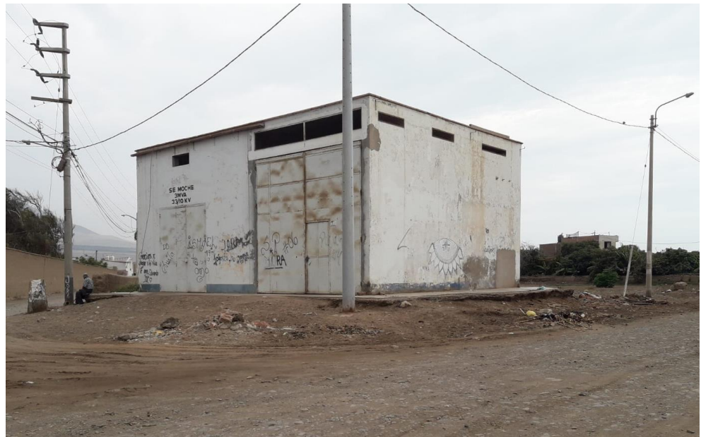
FOTOGRAFIA N° 33: Sub estación eléctrica de moche, ubicado frente al terreno Fuente: Trabajo de campo
