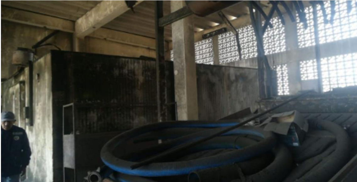
Imagen 10: Zona de elaboración de hielo, estado actual 2022
