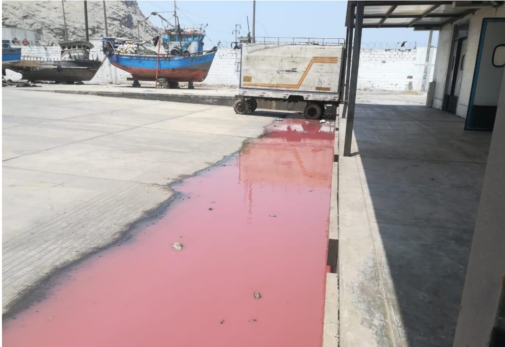
Imagen 8: Zona de carga, empozamiento de aguas residuales -estado actual 2022
