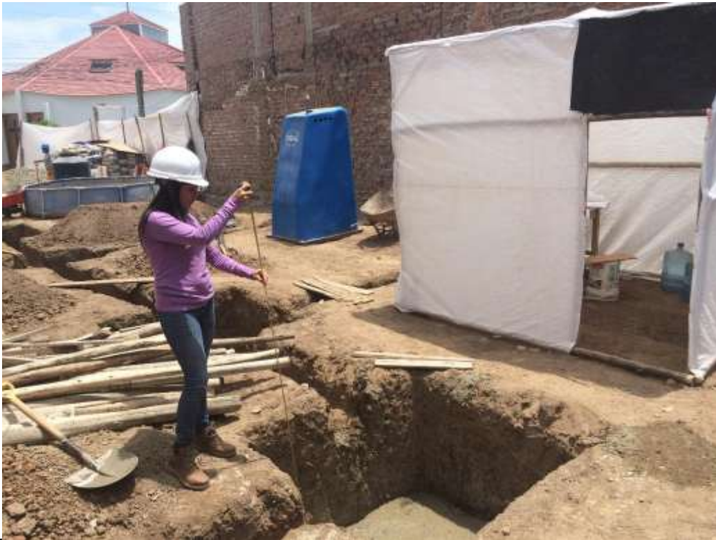
Brenda García Coronado verificando el metrado en obra de acuerdo al avance programado.
