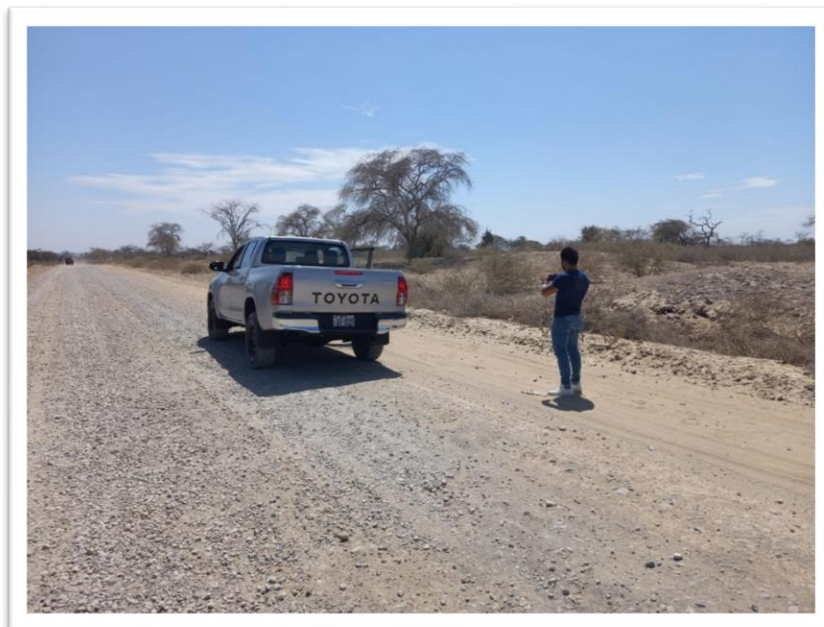
Foto 02: Se aprecia tramo en tangente con una plataforma plana con material de afirmado en estructura regular y funcionalidad regular se aprecia deformaciones de la rasante.
