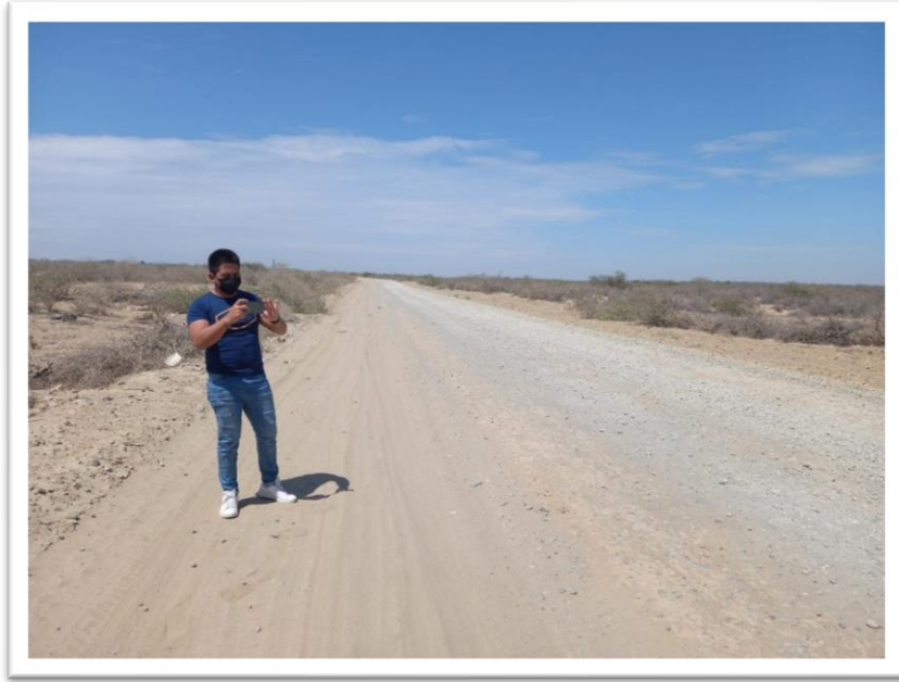
Foto 03: en los lados laterales de la plataforma se aprecia la falta de afirmado y ligeros baches.
