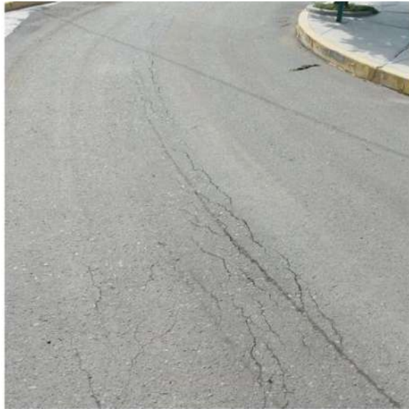
Figura 26. Fisuramiento longitudinal en zona de giro, progresiva 0+480
