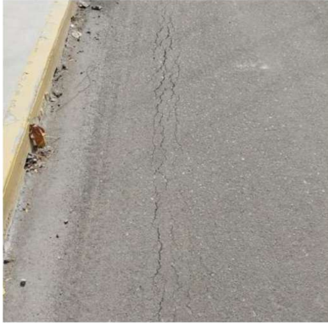
Figura 24. Fisuramiento longitudinal en la progresiva 0+445
