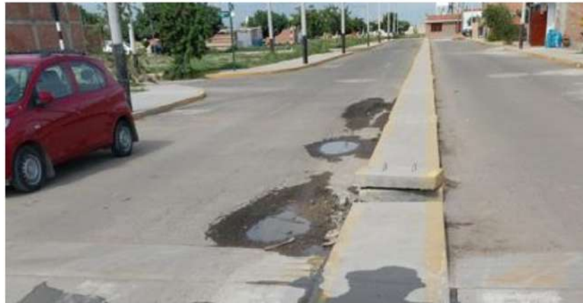
Figura 21. Hundimientos y bacheo en la progresiva 0+335.
