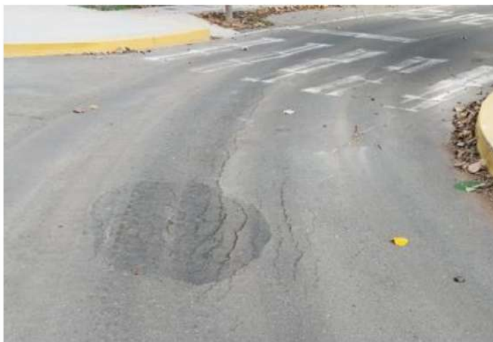
Figura 18. Ahuellamiento y piel de cocodrilo en la progresiva 0+155
