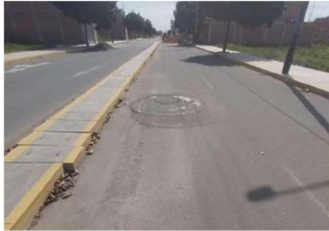
Figura 30. Ahuellamiento en la progresiva 0+720.
