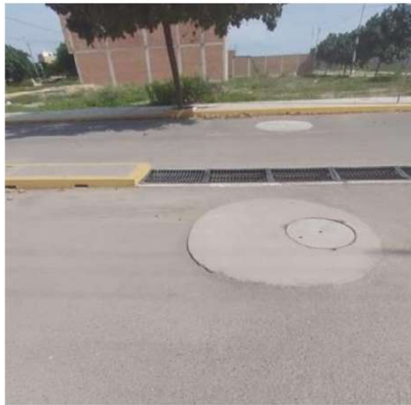
Figura 27. Hundimiento de la carpeta en la progresiva 0+495.
