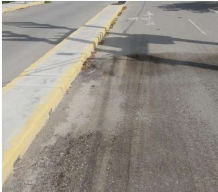
Figura 25. Degradación de la capa de asfalto por la acción de aceite derramado, progresiva 0+465
