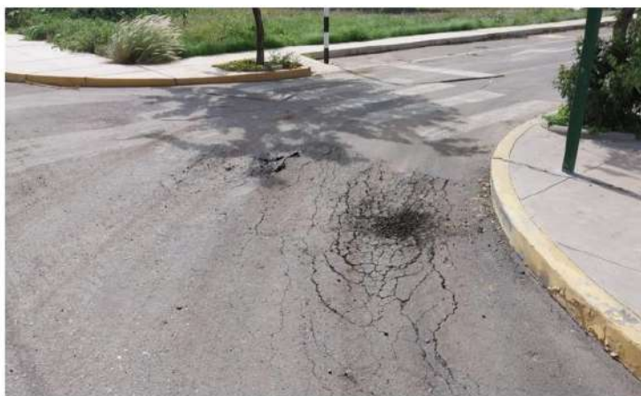
Figura 19. Ahuellamiento y piel de cocodrilo en la progresiva 0+172
