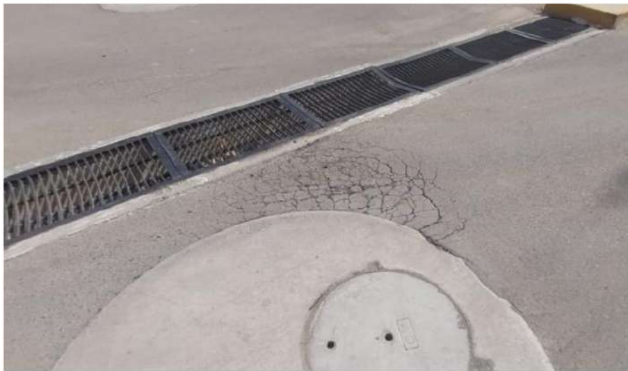
Figura 29. Hundimiento y piel de cocodrilo en la progresiva 0+630.
