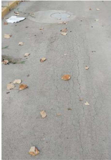
Figura 20. Piel de cocodrilo en la capa de asfalto en la progresiva 0+275.
