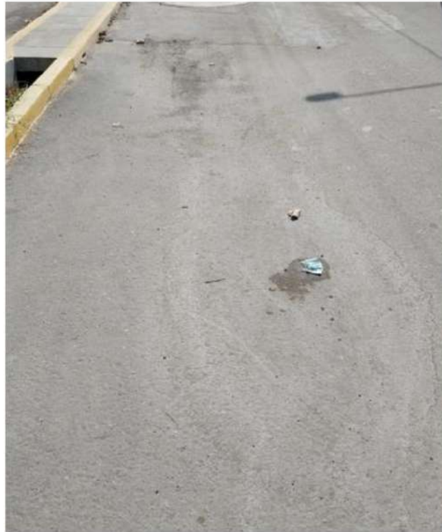
Figura 31. Ahuellamiento en la progresiva 0+800.
