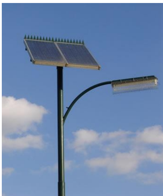
Fotografía N°2: Vista de Panel solar y luminaria pública
