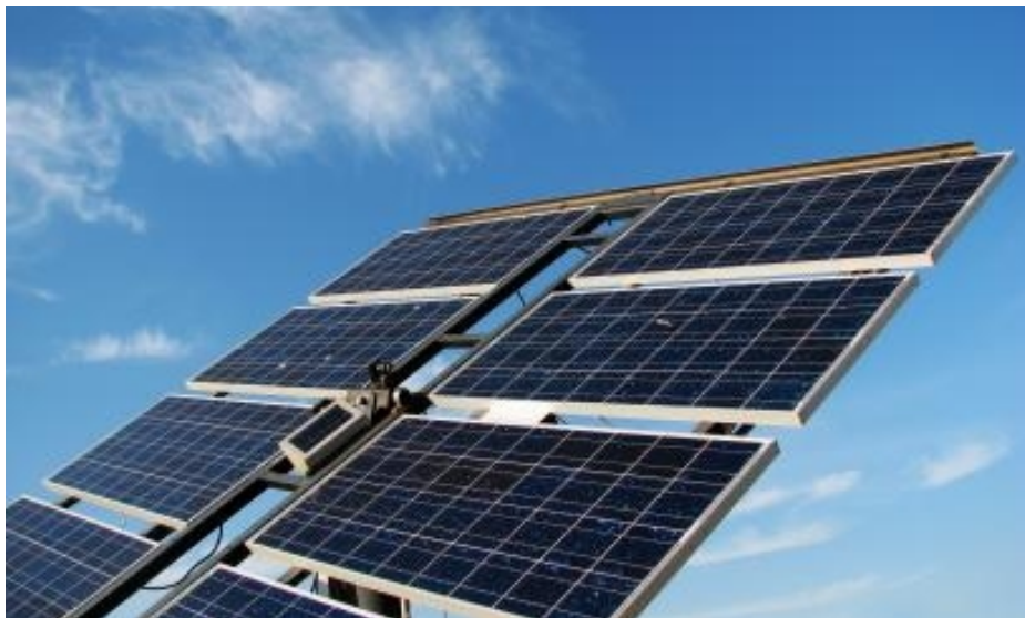
Fotografía N° 11 : Vista de central Fotovoltaica de Tacna.
