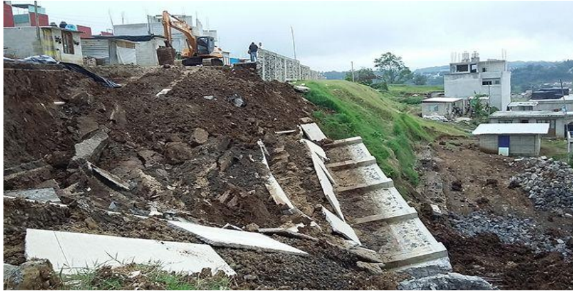
Figura 10: En esta imagen se aprecia el derrumbe de una ladera por falta de un muro de contención.
