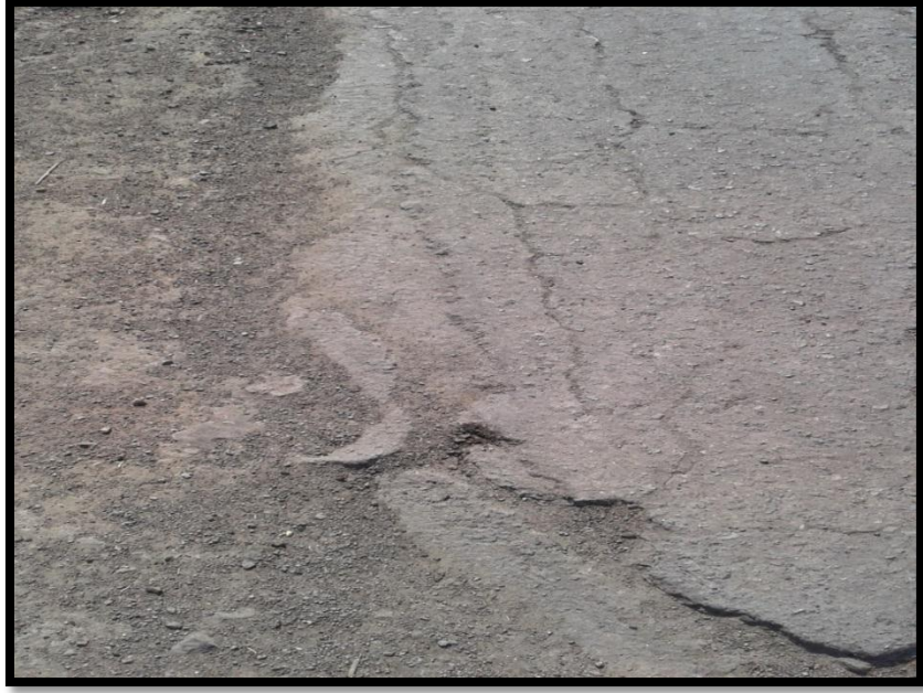
Fisuramiento de Borde
