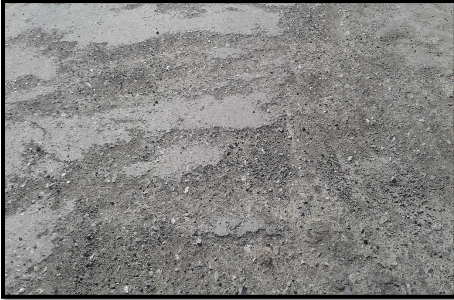
Desprendimiento de Finos
