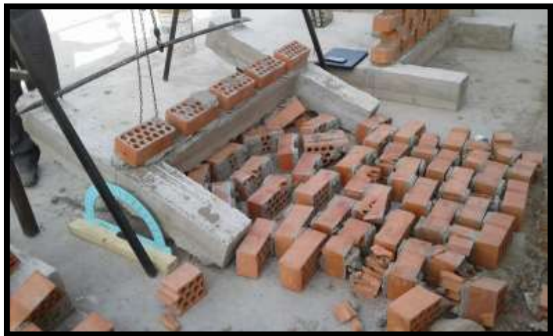
Fig. 2.43. Colapso de Muro No Reforzado.
