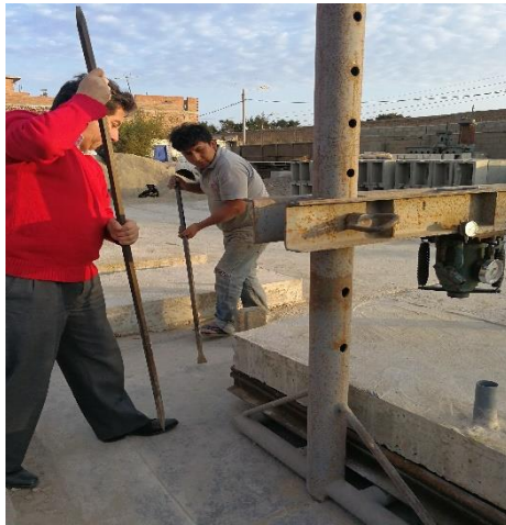
Imagen N° 57. Acomodando la losa aligerada con tubería para que su centro geométrico coincida con el centro de la gata.
