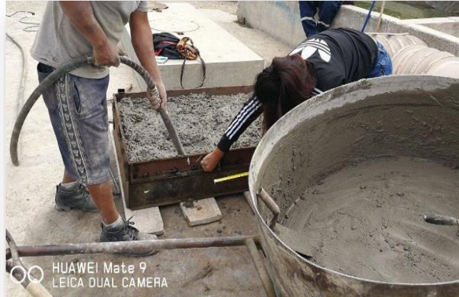
Imagen N° 42. Se tuvo mucho cuidado con el vibrado en las viguetas de borde ya que se podría salir la mezcla por esos lugares.
