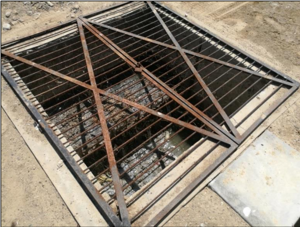
Fotografía n° 9. 5: Canal de entrada actual y medidor de Parshall
