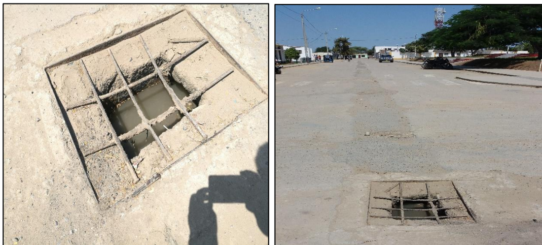
Fotografía n° 9. 4: Buzón de inspección en la plaza de armas del centro poblado
