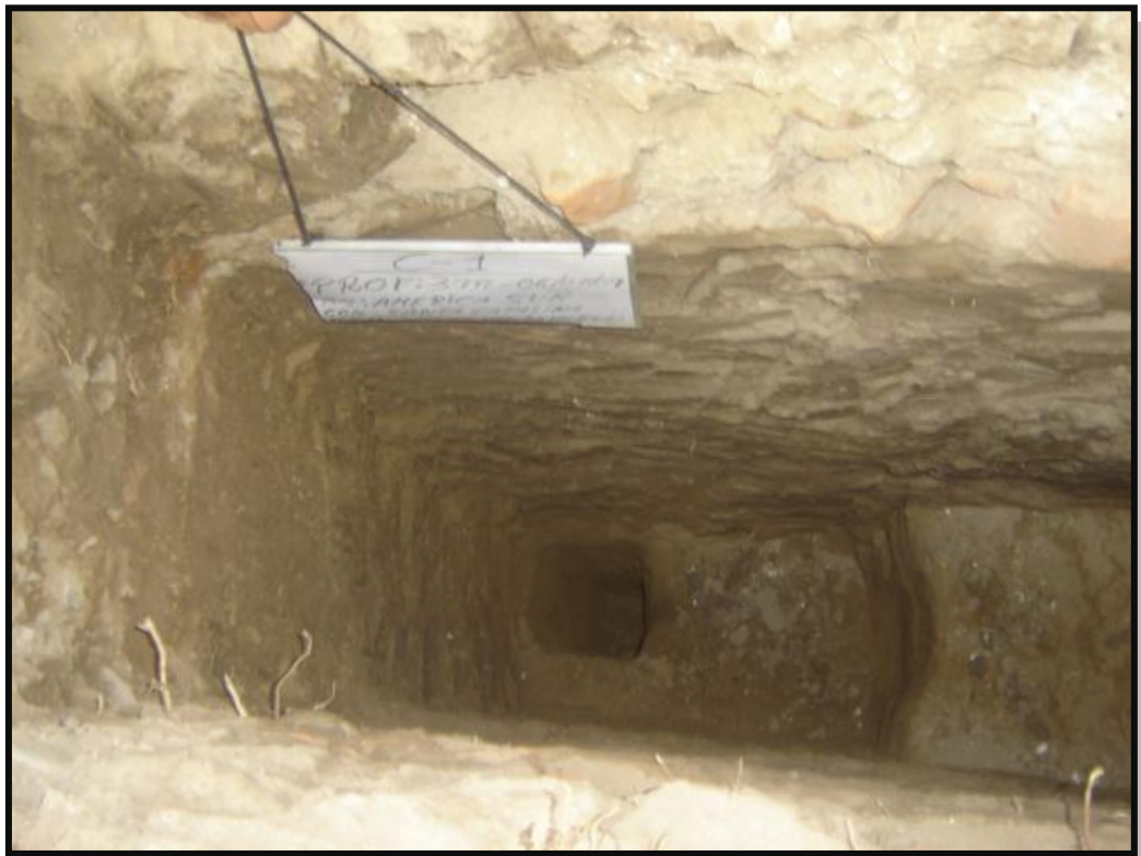
FOTO 9: Vista de la Calicata realizada por SL DE INGENIERIA EIRL, en la Av. América Sur – Trujillo (Zona IV)
