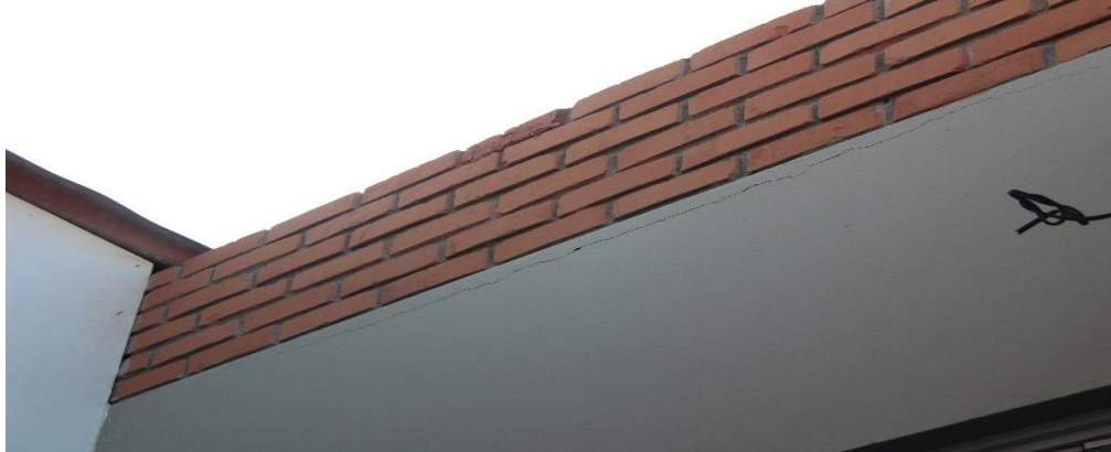
Foto 19: Parapeto en la azotea ligeramente dañado
