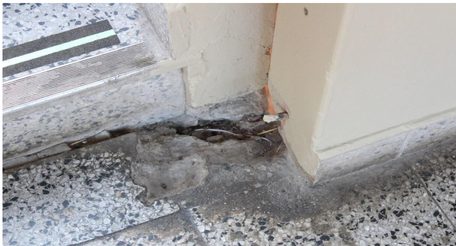
Foto 23: Junta de dilatación en mal estado
