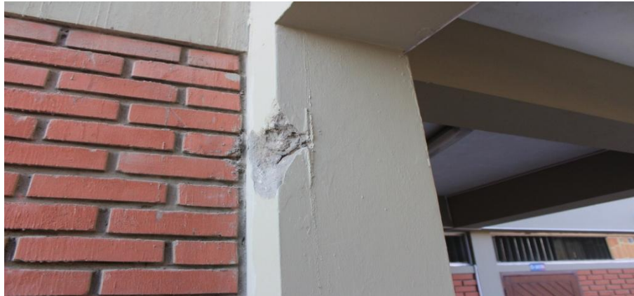
Foto 22: Daño ligero de columna
