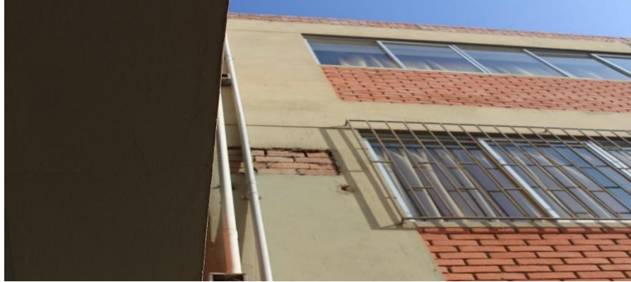
Foto 21: Alteración del elemento Estructural
